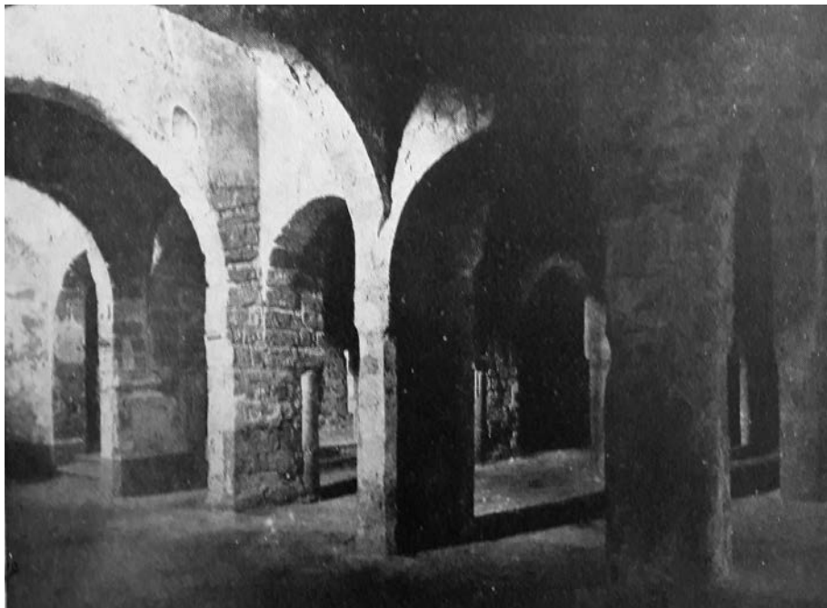
Figura 14. Estado que presentaba el interior del santuario del Castillo de San Marcos en 1914, donde se aprecia el derribo de las bóvedas. Revista "Cruzados"
