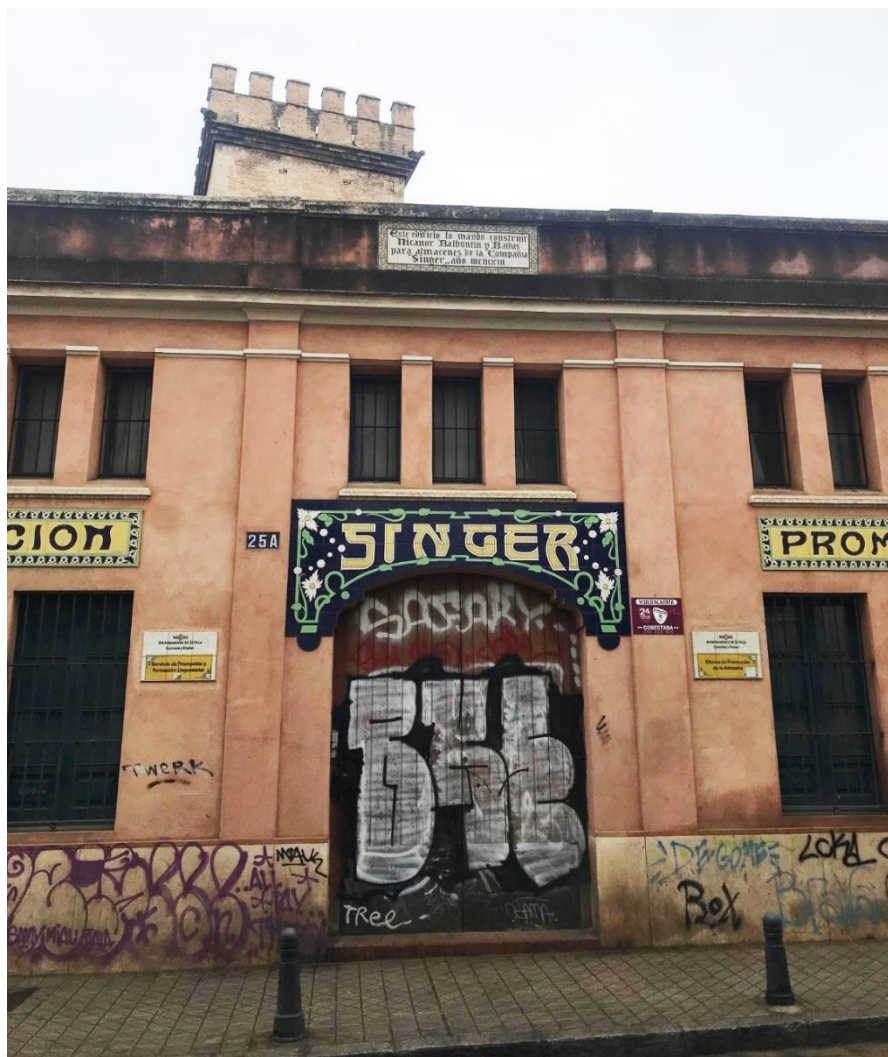
Fig. 46 Fotografía del estado actual de la fachada de la nave Singer. EP
