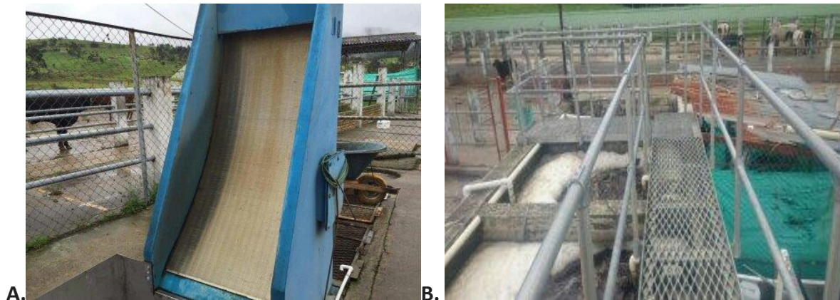
Figura 2. Planta de tratamiento de agua residual de la planta de beneficio del municipio de La Calera. A. Sección de cribado. B. Tanque de aireación. Fuente: Autora.
