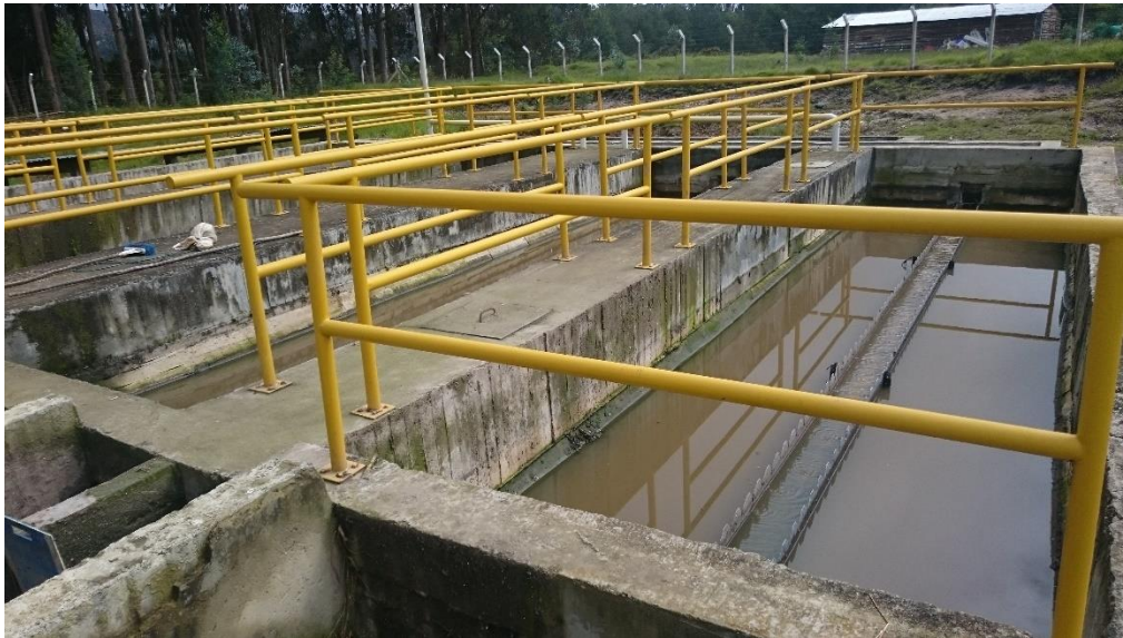
Figura 6. Planta de tratamiento de aguas residuales domésticas del municipio de Guasca. Sección de tanques de sedimentación. Fuente: Autora.
