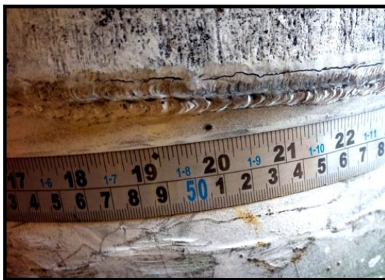
c) Imagen de fisura real en tubería
