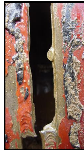
c) Falla soldadura
