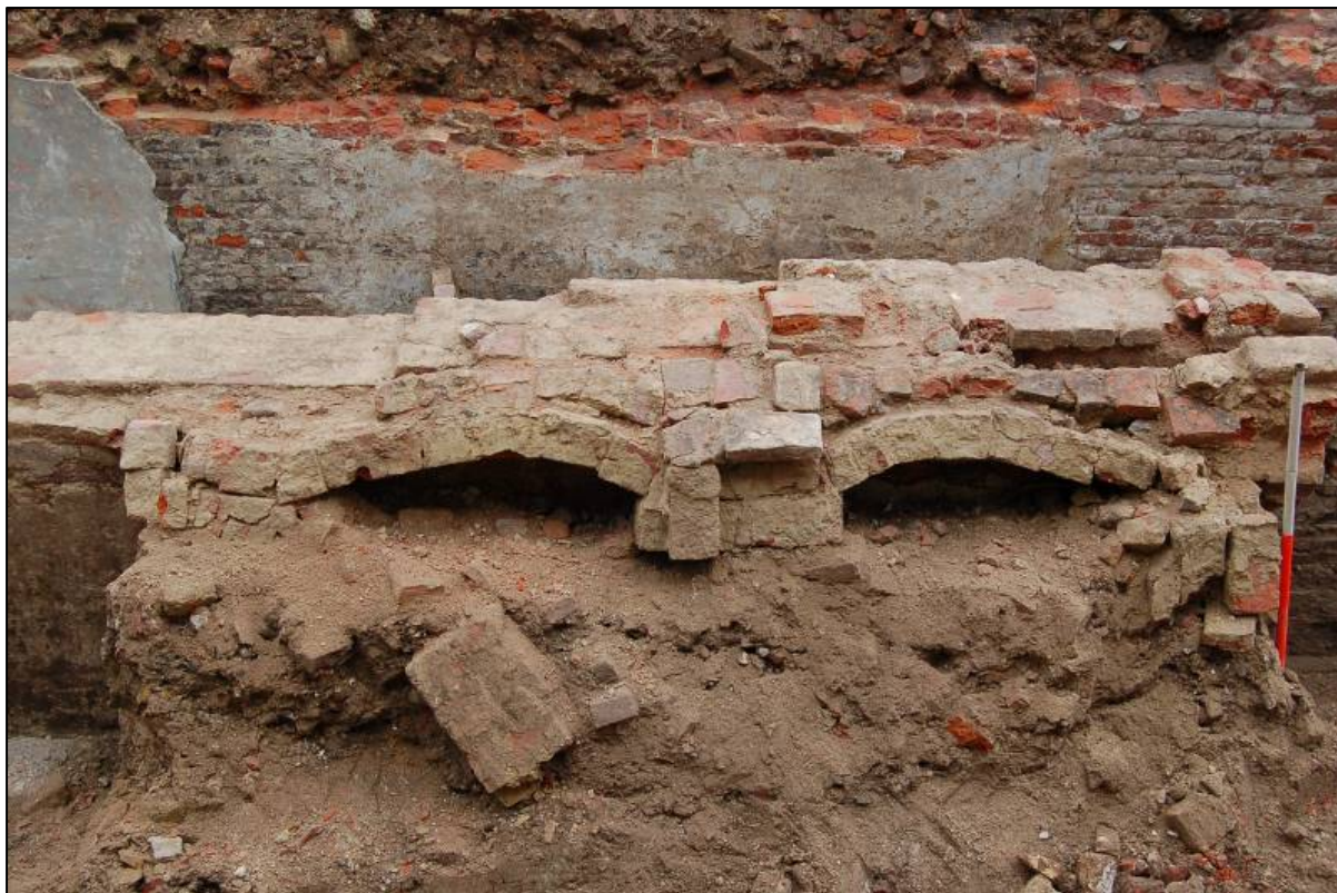
Fig. 20 : gewelfvlakken en gordelbogen ter hoogte van muur S 64. Deze zijn al wat ingezakt, oorspronkelijk hadden ze een iets steilere hoek ten opzichte van de muur. Ze worden op de foto enkel overeind gehouden door puinlaag S 40.
