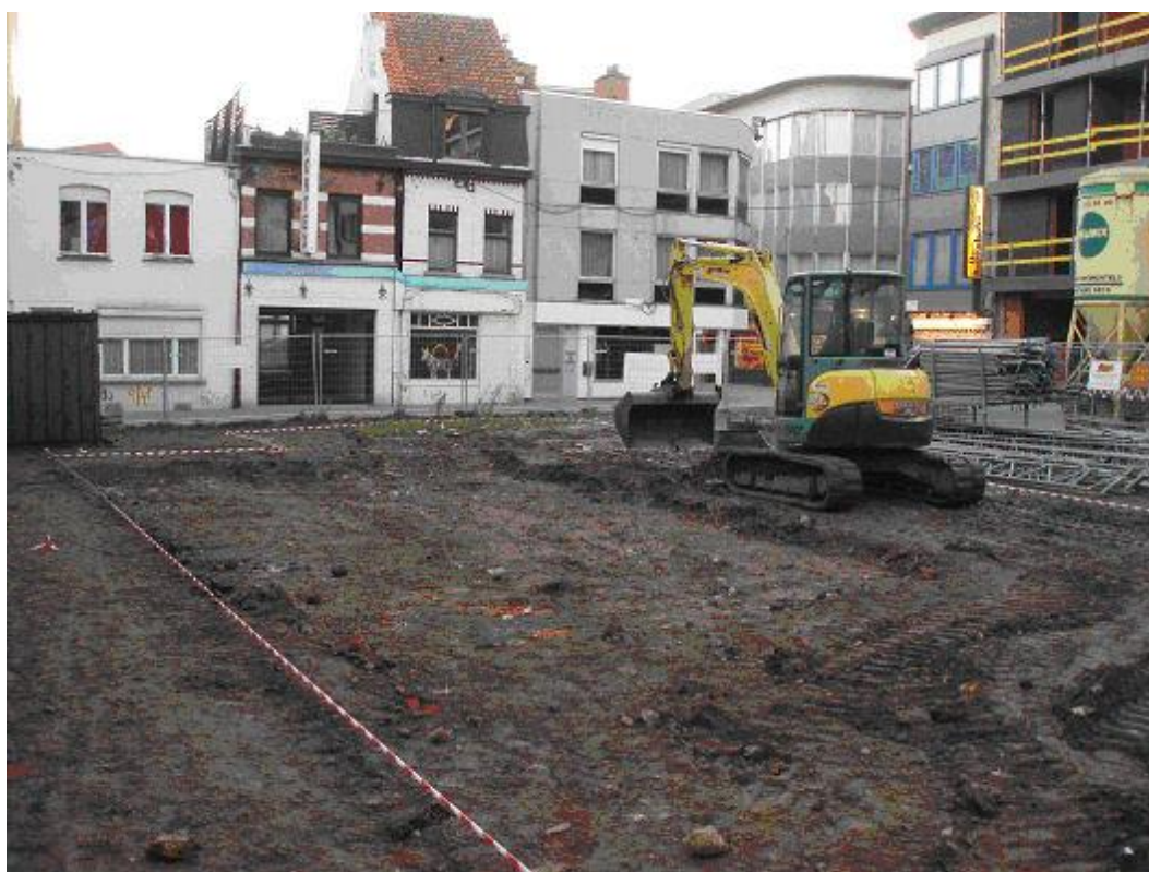
Figuur 3: Machinaal afgraven van de bovenste laag in sleuf 1 van zone Ia, gezien vanuit het noordwesten.
