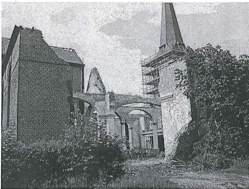
Figuur 14: Buitenmuur M 5, grotendeels weggebroken (foto B. Acke).
