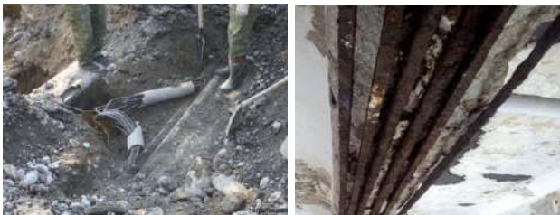
Рис. 3 – Приклади пошкодження комунікацій
