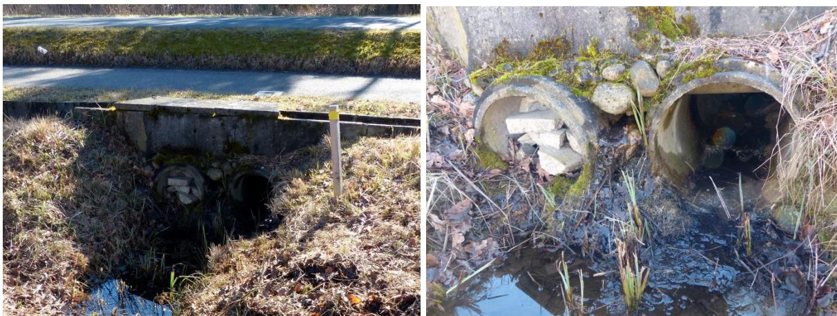
Abbildung 112, 113: Das Bildpaar zeigt die Situation des Einfallschachtes mit den darunterliegenden Röhren, von denen die seewärts führende rückseitig verstopft ist um die in den Schacht gefallenen Tiere korrekt zu leiten.
