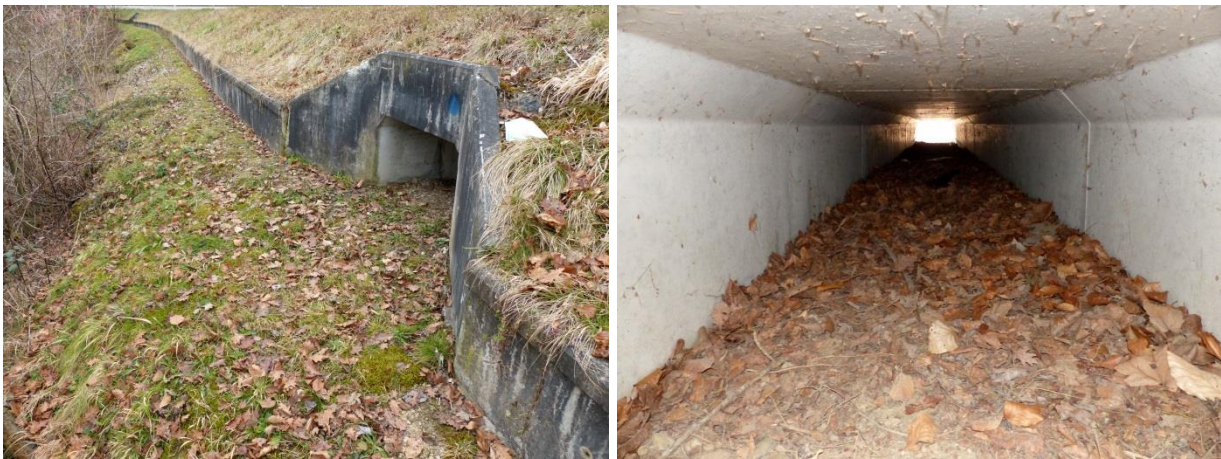
Abbildung 10, 11: Zweiweg-Durchlass beim Standort Leuggern. Das breite Profil mit dem Naturboden als Lauffläche ergibt einen den aktuellen Standards (VSS-Norm) entsprechenden Durchlass mit grossem Lichtkegel.
