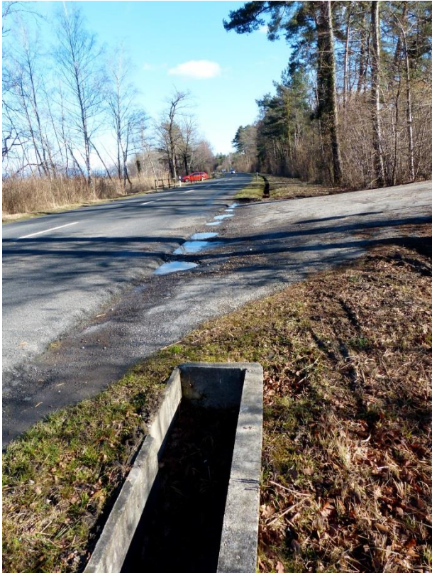
Abbildung 115: Zur Kantonsstrasse zuführender Weg ohne Schutzmassnahmen. Die anwandernden Tiere können an dieser Stelle direkt auf die Strasse gelangen.
