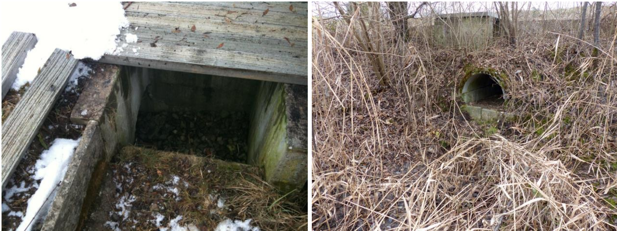
Abbildung 56, 57: Schacht- und Tunnelsystem der Leitanlage in Kirchberg. Die Tiere werden in einen Fallschacht geführt (Bild links), mit teilweiser entfernter Verdunkelungsabdeckung zur Dokumentation. Auf der rechten Bild ist die Südseite der Leitanlage sichtbar mit dem Fallschacht entlang der Leitstruktur sowie der Ausgang des Schachtes, welcher von der Nordseite her nach Süden führt.
