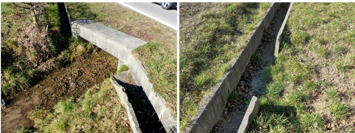
Abbildung 91, 92: Im Bild links zu erkennen ist der am südlichen Ran der Anlage befindliche Bachdurchlass innerhalb des Leitsystems. Das Bild rechts zeigt Ausstiegsbereich in den Sammelkanälen für Tiere, die nicht auf die andere Strassenseite wandern möchten und sonst nicht aus dem Sammelkanal hinaus kommen würden.
