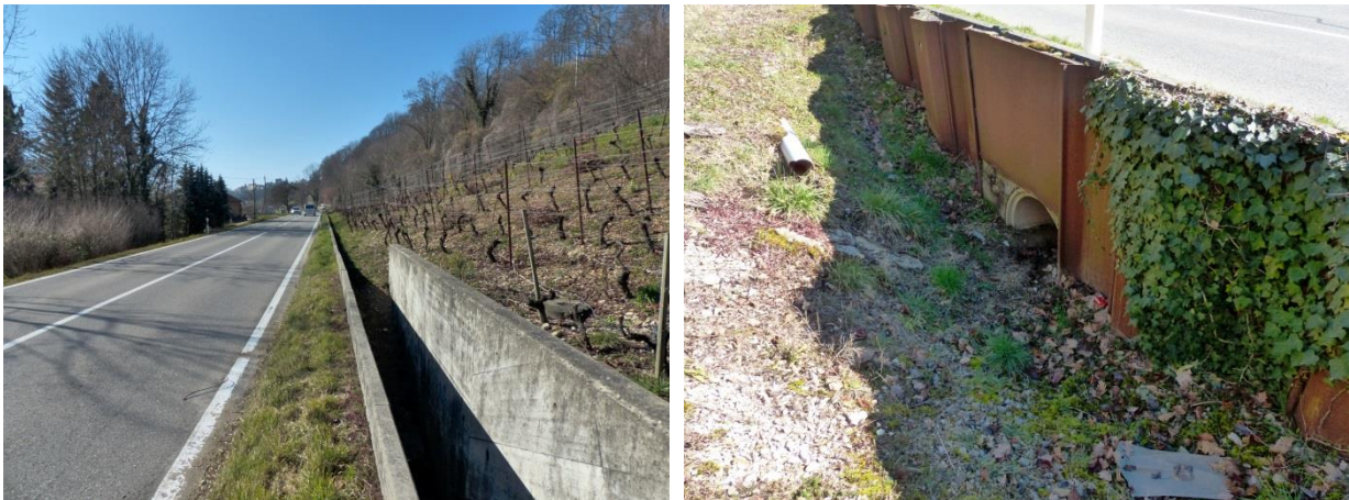
Abbildung 97, 98: Zur Unterführung der Strasse müssen zum Teil erhebliche Geländeabsenkungen gestaltet werden hin zu den Durchlässen. Die Durchlässe weisen keine Einweisungselemente auf.
