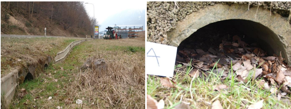
Abbildung 106, 107: Im Bild links sind zwei nahe zueinander angeordneten Tunneleingänge zu erkennen. Das Bild rechts zeigt die mit etwa zur Hälfte mit eingespültem Material verfüllte Tunnelröhre.
