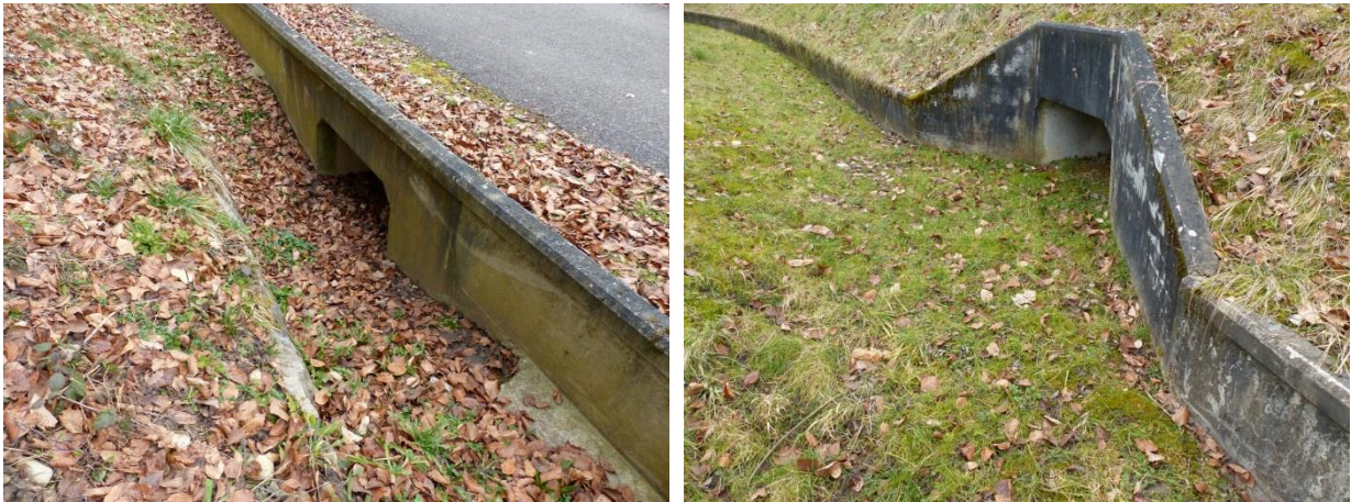
Abbildung 67, 68: Auf den Bildern sind die Gestaltung, Einsenkung im Gelände, der trichterförmigen Einweisung und der Durchlässe zu erkennen. Seeseitig sind die Leitwerke trichterförmig.
