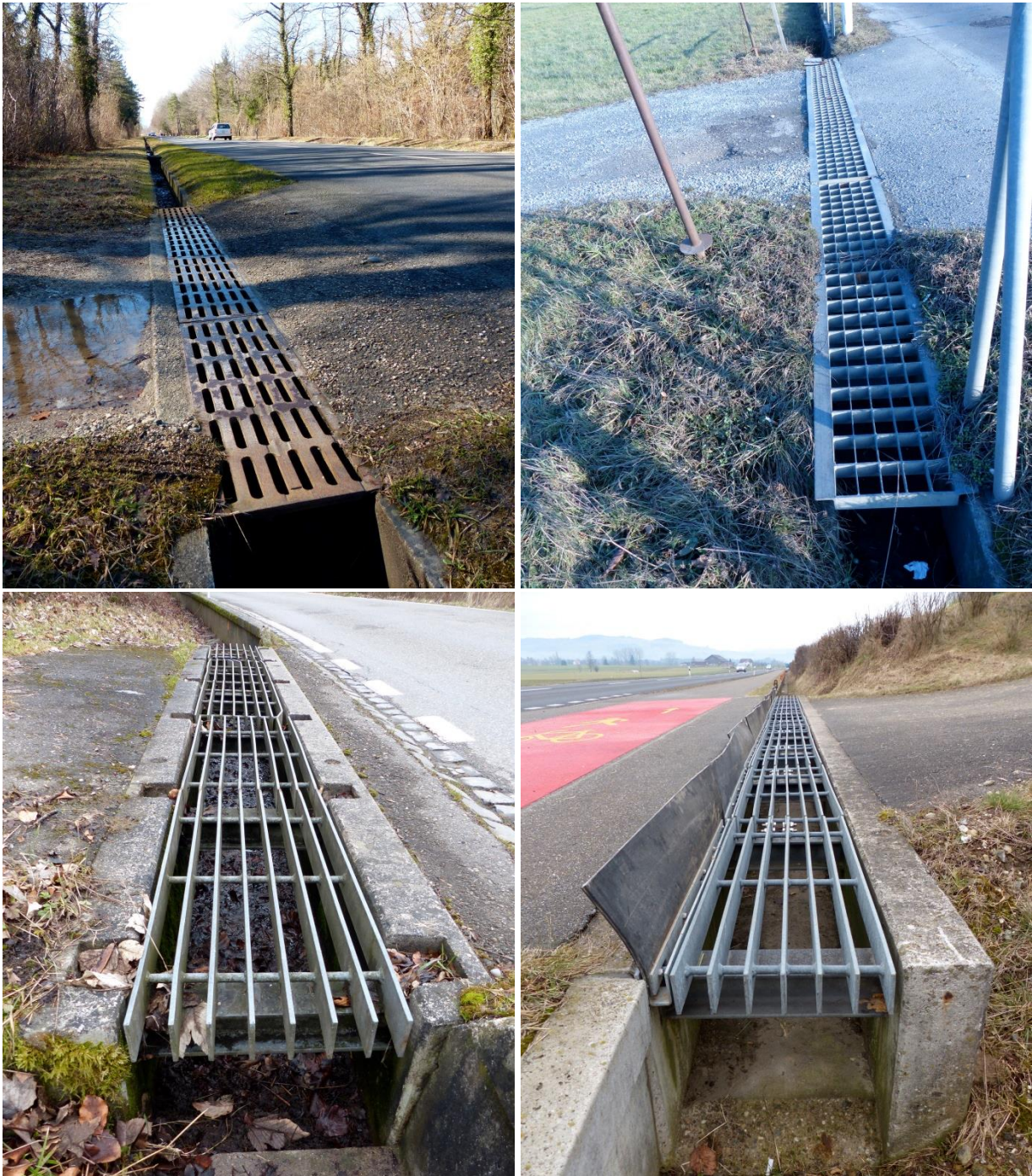
Abbildung 17-20: Beispiele von Schutzmassnahmen (Gitterroste) bei seitlich in die Anlage führenden Wegen in verschiedenen Untersuchungsstandorten. Von links oben nach rechts unten: Yvonand, Oberuzwil, Dätttau, Kottwil. Der Gitterrost in Yvonand dürfte von vielen Amphibien passiert werden können, wegen der relativ breiten Lauffläche zwischen den Lücken. Besser dürfte diesbezüglich die weiteren dargestellten Varianten sein, wobei auch hier sich Amphibien möglicherweise durchhangeln können.
