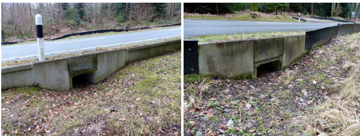
Abbildung 117, 118: Ansicht der Durchlässe west- und ostseitig, jeweils leicht ins Gelände eingesenkt und ohne trichterförmige Gestaltung des Eingangsbereiches und auch ohne Einweisungselemente.
