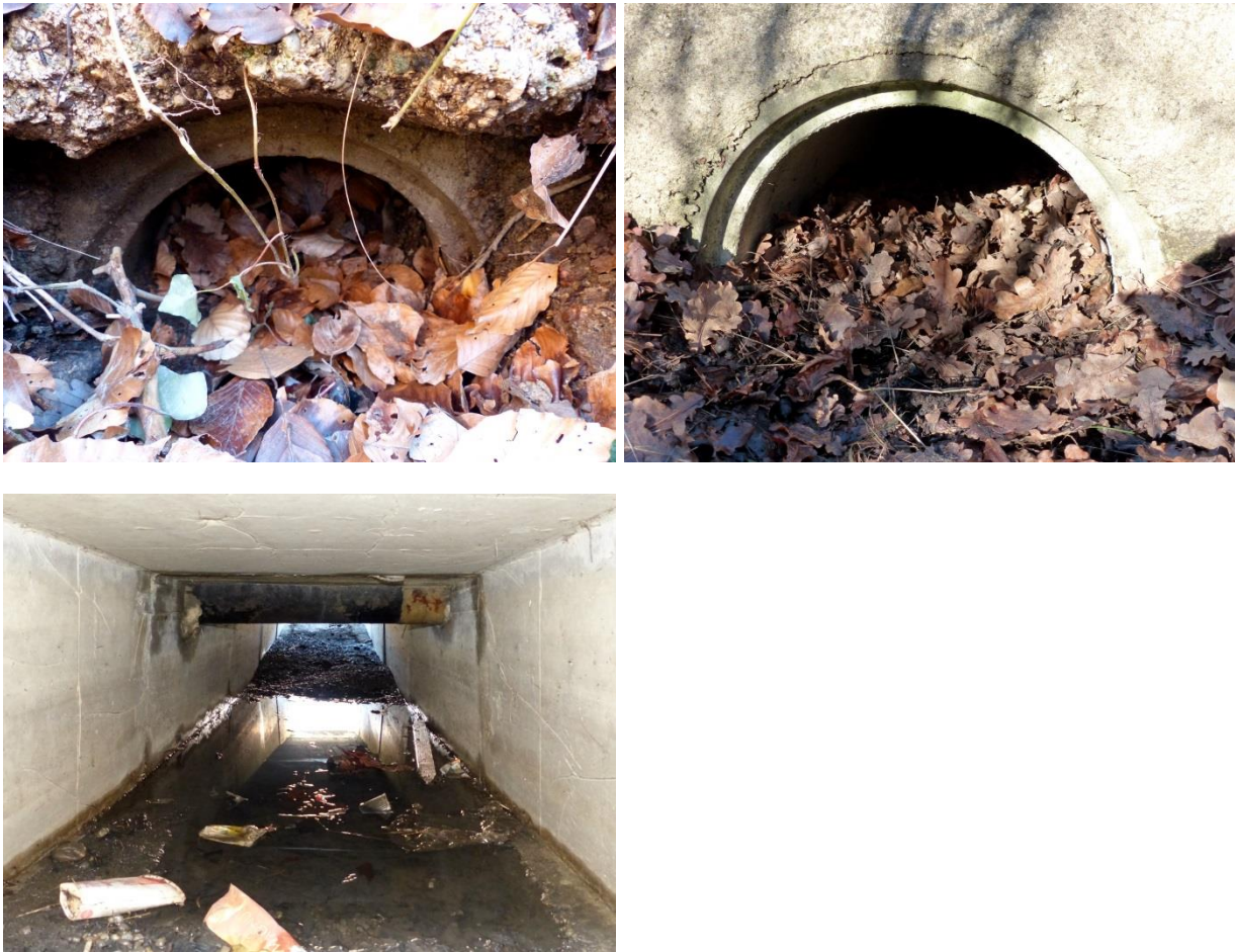
Abbildung 12-14: Röhren-Durchlässe in Cossonay und Yvonand. Bei einzelnen Durchlässen wurde ein schwemmes Material zu wenig entfernt (Aufnahmen vom 12. Februar 2014), die Hälfte des ohnehin schon engen Tunnelquerschnittes ist verfüllt.
