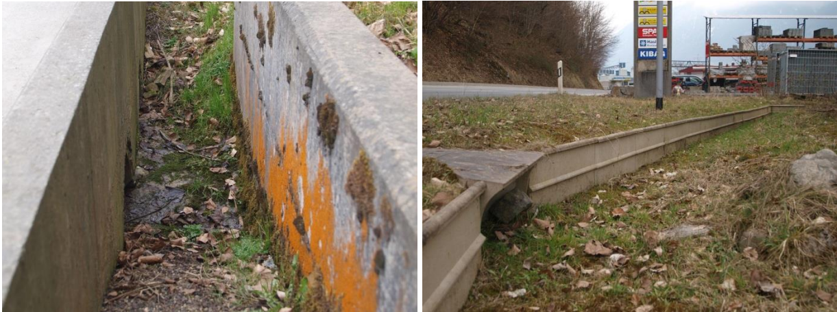
Abbildung 104, 105: Zur Unterführung der Strasse mussten relativ steile Geländeeinschnitte realisiert werden (Bild links). Rechts ist der Ausgang des nachträglich ergänzten Aco-Tunnels zu erkennen.
