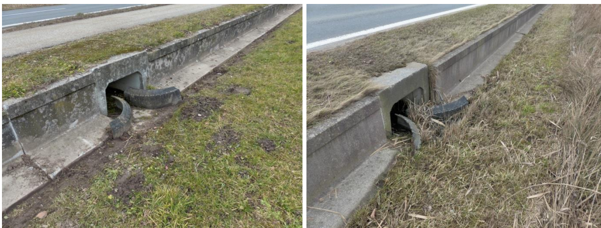
Abbildung 77, 78: Die Tunnel der Leitanlage bestehen aus einem Kastenprofil mit Betonlauffläche, die mit Lehm bestrichen wurden. Als Einweis-Elemente wurden Pneus verwendet.
