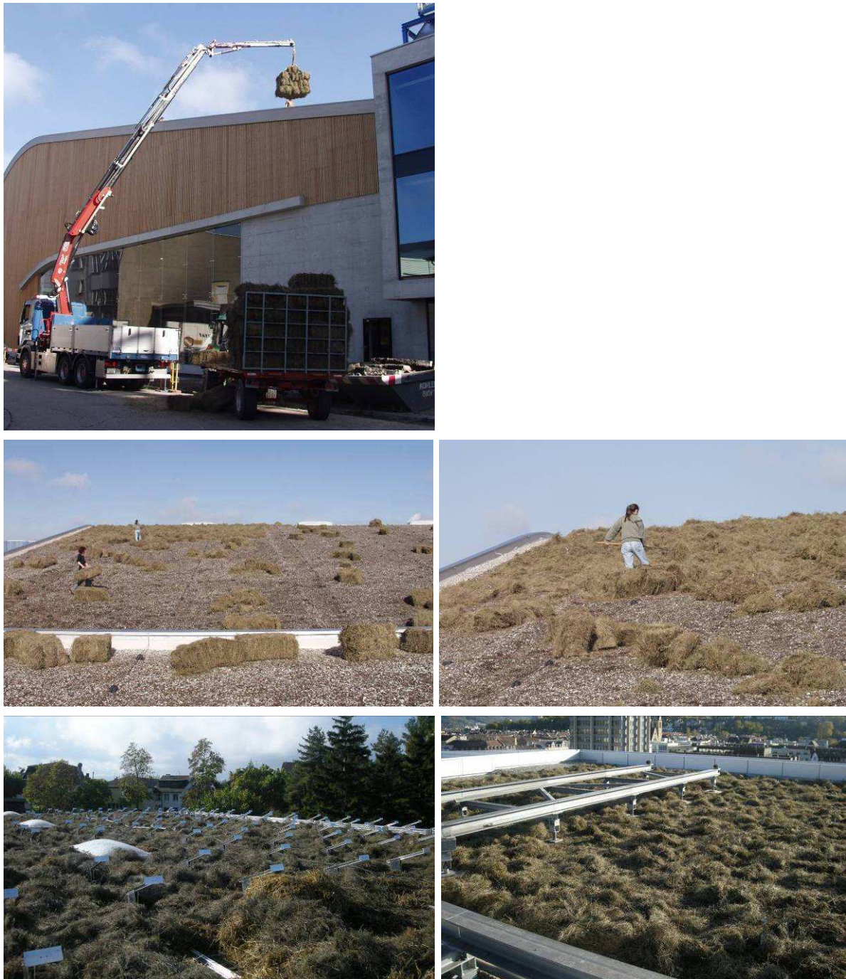
Abbildung 25-28: Versuchsdachbegrünungen auf dem Dach des Holzkraftwerkes der KVA Basel (oben und Mitte). Zu sehen ist wie die Heuballen auf dem Dach verteilt werden. Die unteren Abbildungen zeigen die fertig eingerichteten weiteren Dachflächen auf der Lagerhalle des Steinlagerplatz des Tiefbauamts Basel-Stadt vor der Montage der Fotovoltaikpaneele sowie dem Jacob Burckhardt-Haus in Basel. Fotos: Stephan Brenneisen und Lidia Crepet
