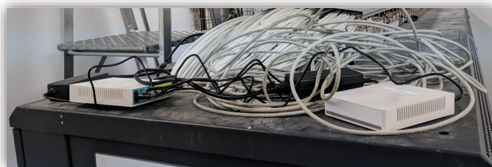
Figura 17 – Instalación de los dos encaminadores Mikrotik
