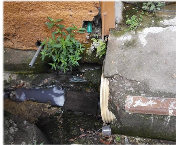
Figura 5.10 Aguas residuales evacuadas mediante alcantarillado en Calle Bajo Anonos y dirigidas al río.
