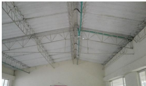
Figura 94. Fotografías estructura tipo cercha segundo nivel
