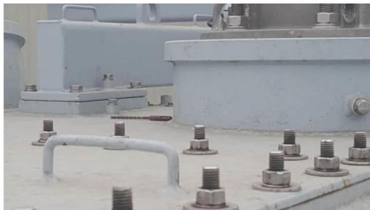
Imagen 58. Objeto tirado en la cubierta del transformador.
