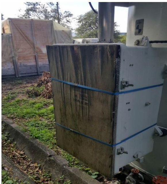
Imagen 68. Huacal del gabinete de control.
