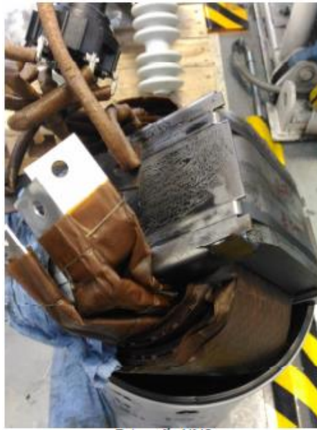
Imagen 68.4. Daño en la parte activa por causa del cortocircuito.
