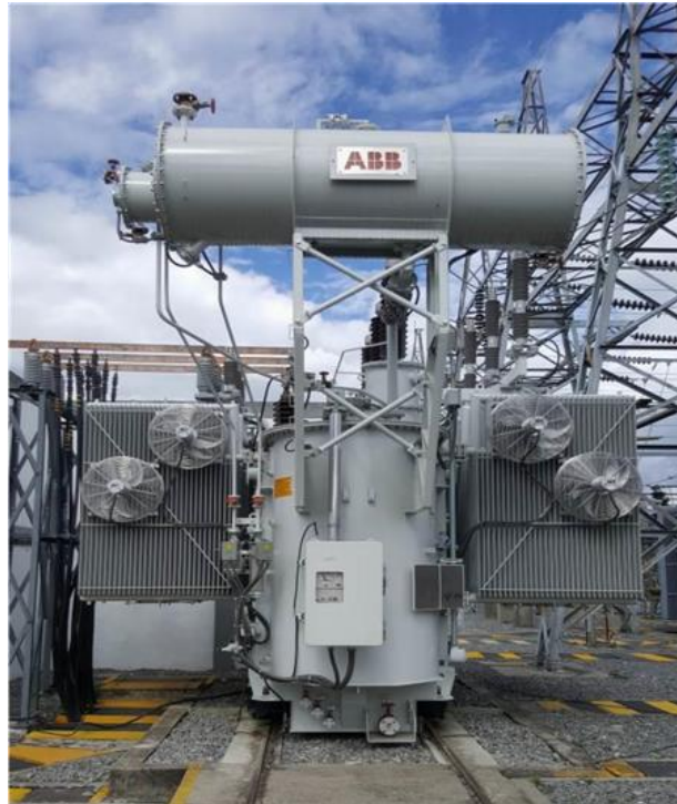
Imagen 52. Transformador 60 MVA subestación principal CEO en Popayán.
