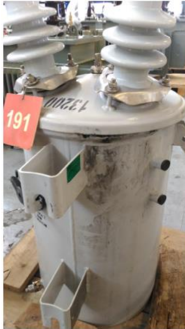
Imagen 68.3. Fuga se aceite por tapa del transformador causada por las fuerzas axiales post-cortocircuito.
