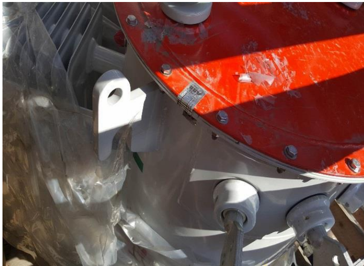
Imagen 62. Transformador monofásico ELGAMA, con el plástico ya deteriorado.
