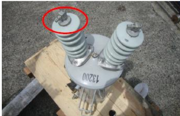
Imagen 68.1. Aislador intervenido por el cliente.
