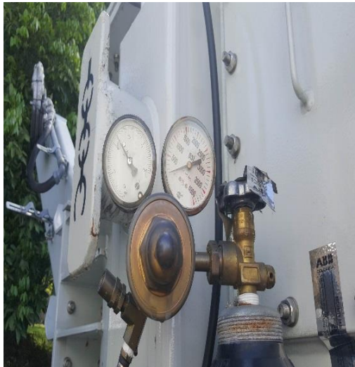
Imagen 67. De izquierda a derecha; Manómetro de presión interna del transformador y manómetro de presión del cilindro de nitrógeno.
