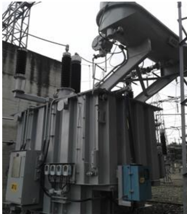
Imagen 63. Transformador monofásico fase S.
