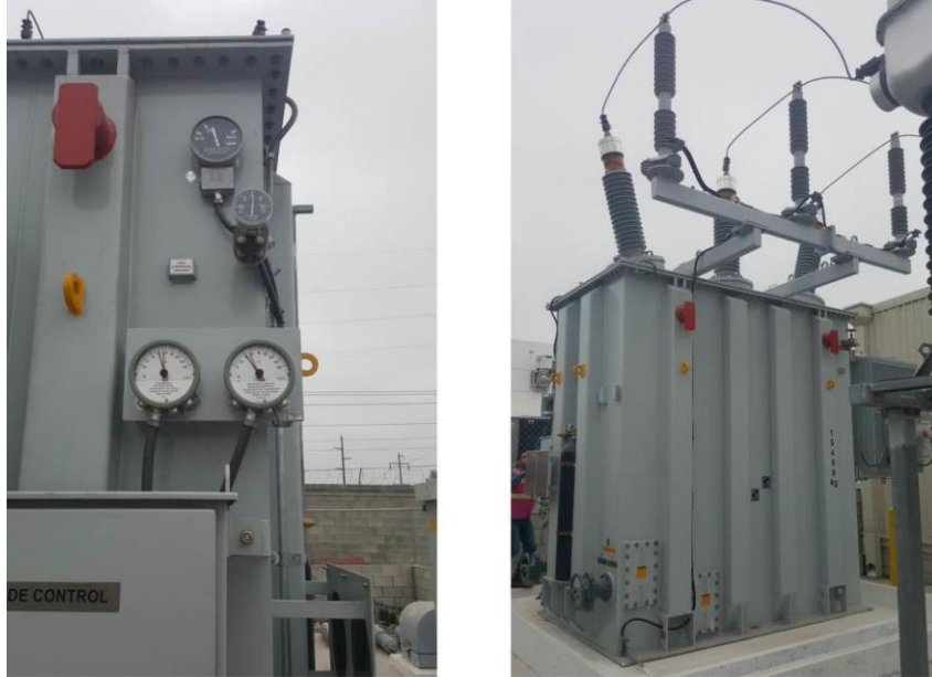
Imagen 57. Transformador 12.5 MVA Covidien y manómetros del sistema Inertaire.
