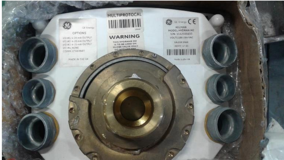
Imagen 64. Dispositivo de análisis de gases Hydran con falla.
