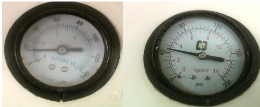
Figura 2. Manómetros para control de presión
