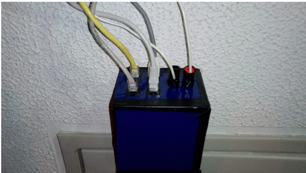
Imagen 3.3 Dispositivo de transmisión de datos correspondiente a la Etapa 3
