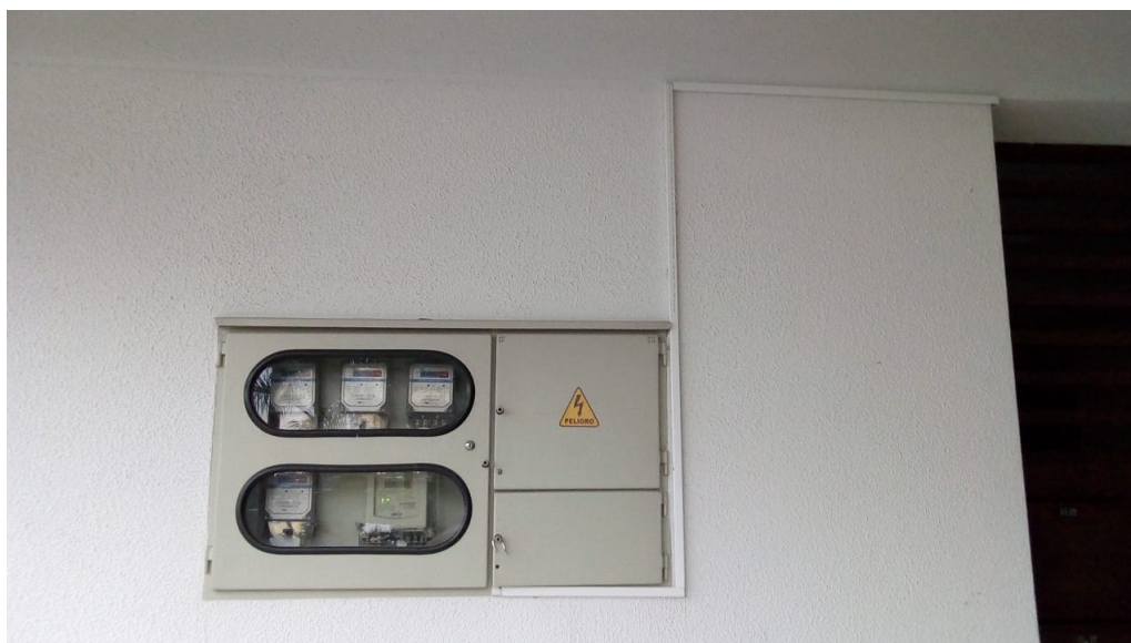
Imagen 3.2.2 Monitoreo de tableros por cable de par trenzado.
