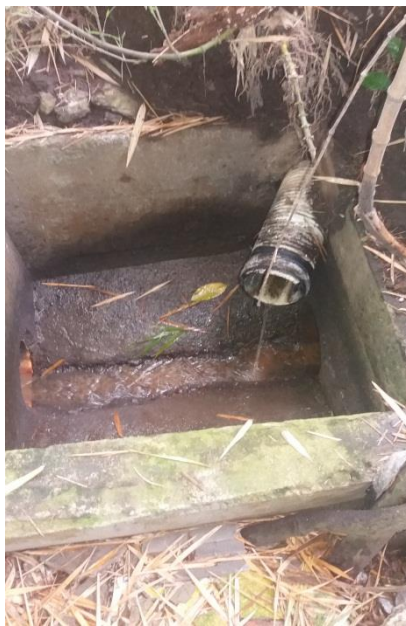
Foto 4. Primer Afluente de Aguas Lluvia
