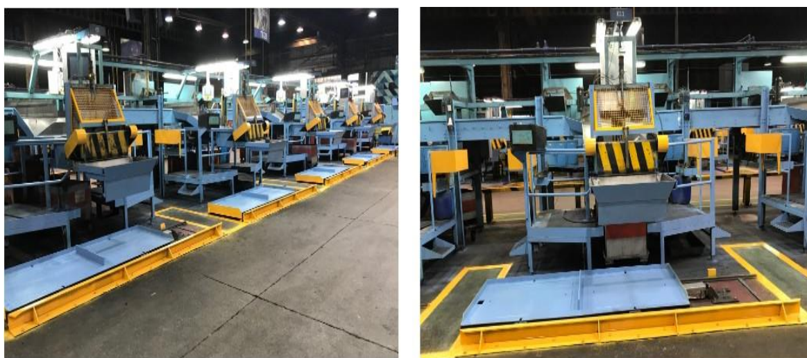
Figura 94 Versão final de linha e postos de controlo instalados na Sakthi
