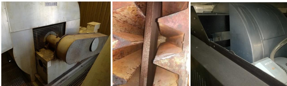
Figura 2.6. Ventilador Zell (esquerda), Jet Box's (centro) e Ventilador Single End (direita).
