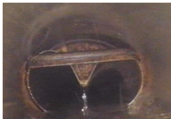
d) Afluências indevidas – Deficiência que pode estar associada a problemas de construção.
