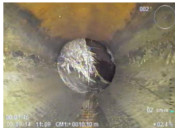
b) Causa externa, intrusão de raízes.
