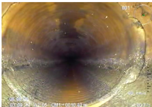
c) Junta partida na ligação entre dois tubos – Deficiência que pode estar associada a incorreções de conceção e projeto e/ou problemas de construção.
