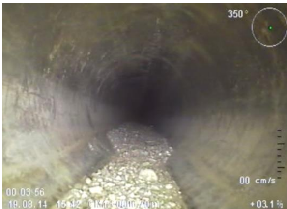
a) Causa interna, acumulação de material sólido.
