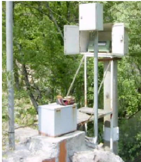
Figura 58 - Estação hidrométrica (fonte: https://snirh.apambiente.pt ).
