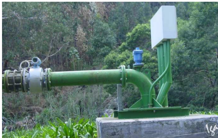
Figura 100 - Furo de captação (vista à superfície) (ARM, 2018).
