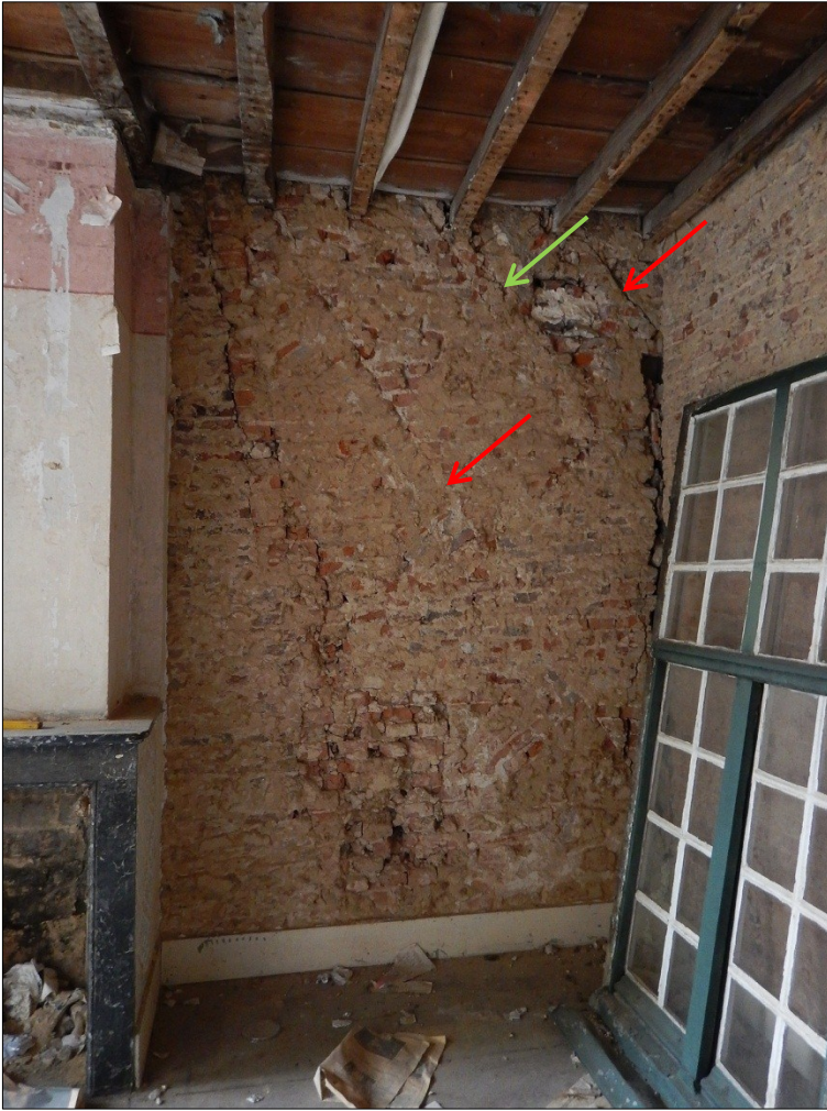
Figuur 14. De bouwsporen van de oudere dakfasen in kamer 38-6 (rood, rechts van de schouw), met aanduiding van de eventuele derde fase (groen).
