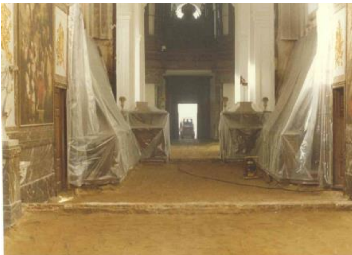
Fig. 4.1: Eerdere uitgraving in het kerkkoor en -schip.
