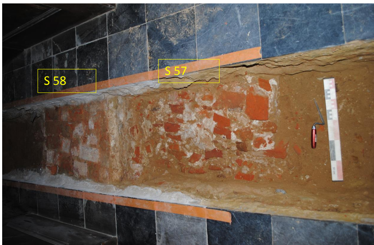
Fig. 5.16: De uitgegraven geul tussen WP 8 en 9 met fundering S 58 en structuur S 57.
