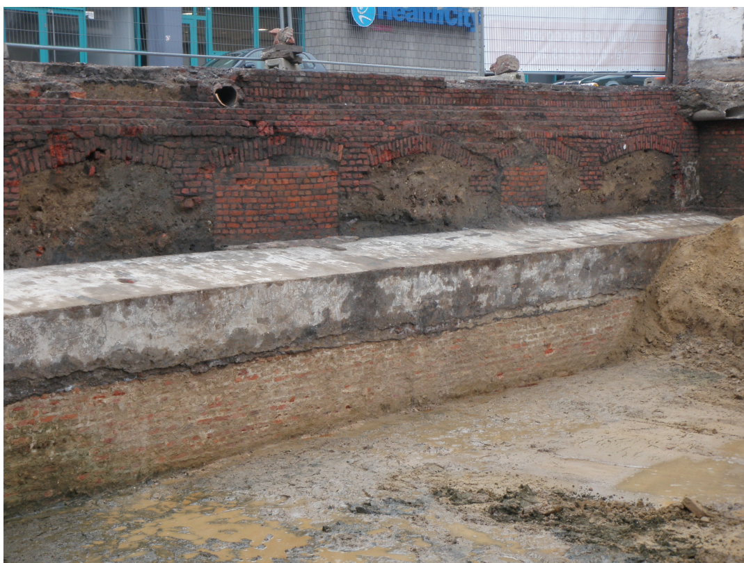
Afbeelding 25: Cementbekleding aan de bovenzijde en de bovenste 50 à 60 cm van de binnenzijde van de contrescarp.
