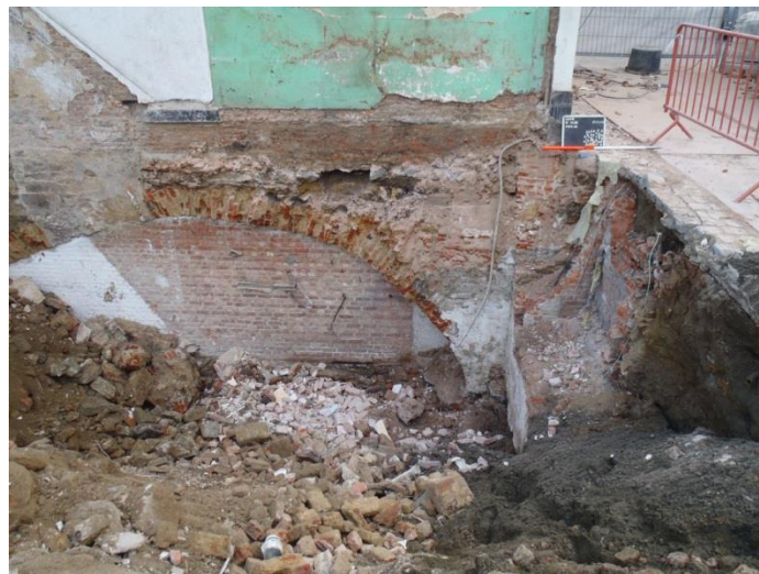
Afbeelding 38. De dichtgemaakte wand tussen kelders op perceel 37m en 37h; foto genomen vanuit het westen.
