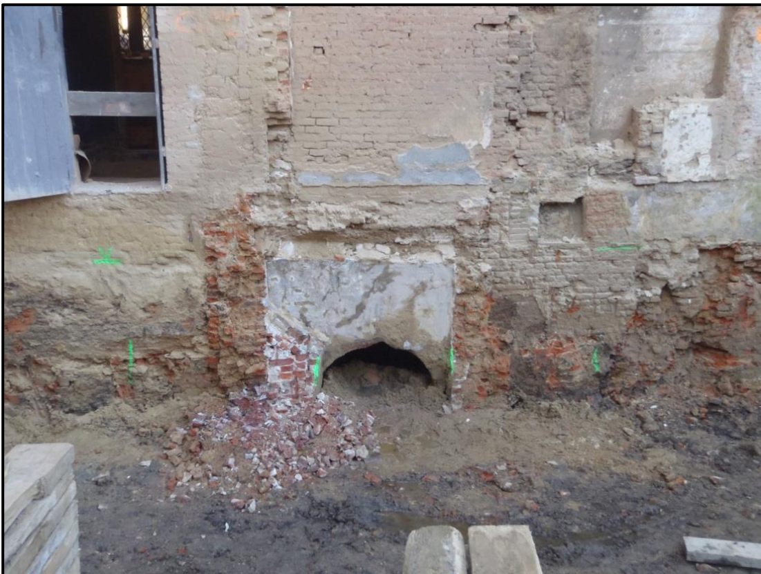
Figuur 84: Na afbraak van Citerne 3 bleek de structuur verbonden te zijn met een kelder onder het aanpalende historische pand (onder de ruimte die 'Salle de réunion' genoemd wordt op de plattegrond van 1914)
