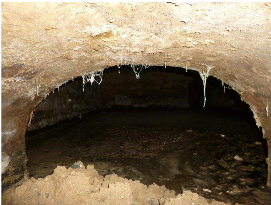
Zicht vanuit de voormalige 'Buanderie' op de holle ruimte onder het gewelf in de 'Salle de Réunion'.
