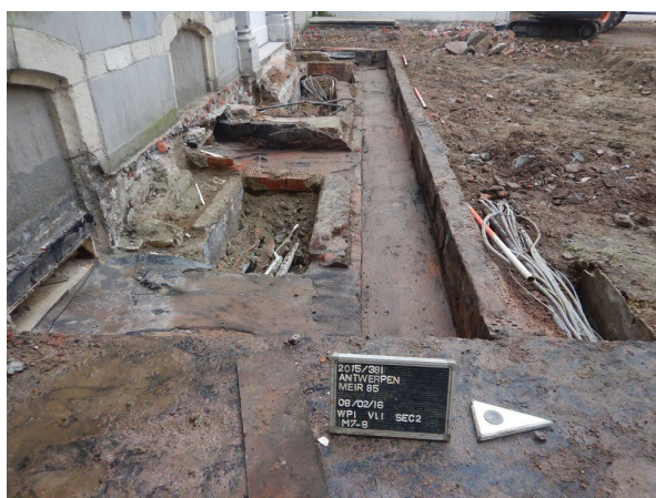
Fig. 82: Kabelgoten, kabels en leidingen langs zuidvleugel binnenkoer (M7-18)
