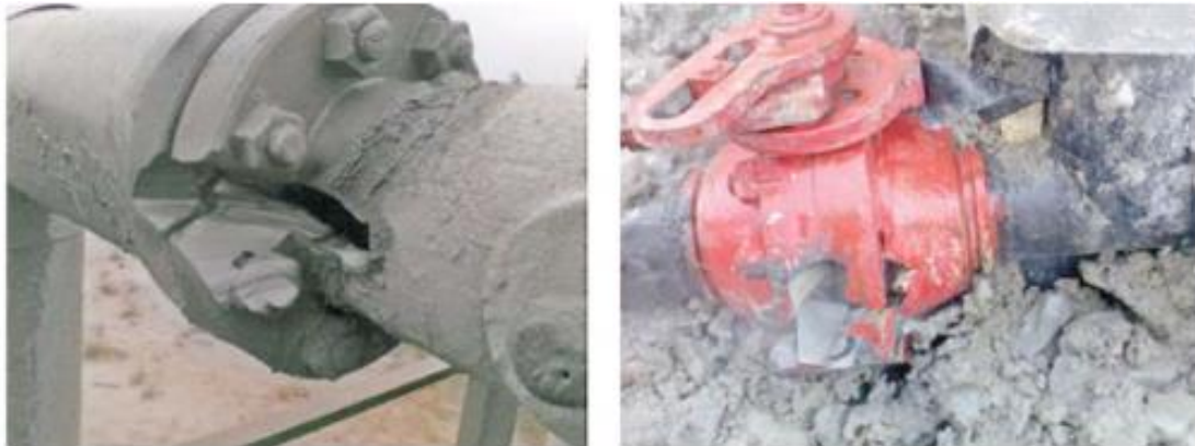
Рис. 1 Разрушение обвязки скважины в результате абразивного износа
