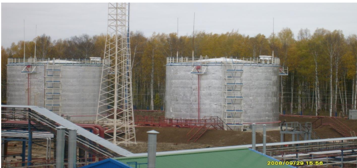
Рисунок 8.1 - Системы пенотушения РВС
