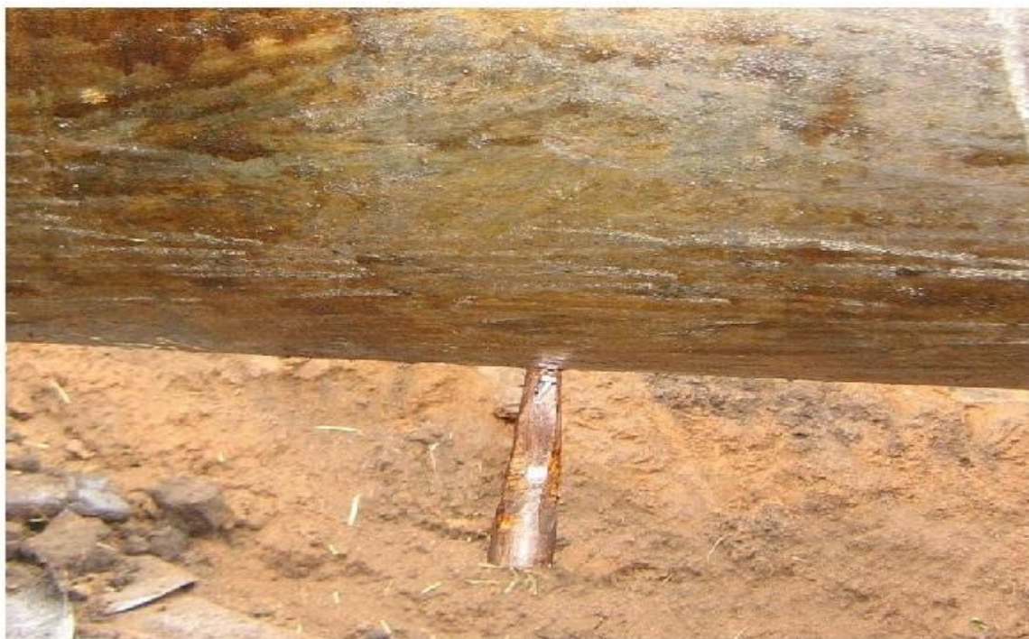
Рисунок 6 - Локализованная течь, образовавшаяся на коррозионном питтинге
