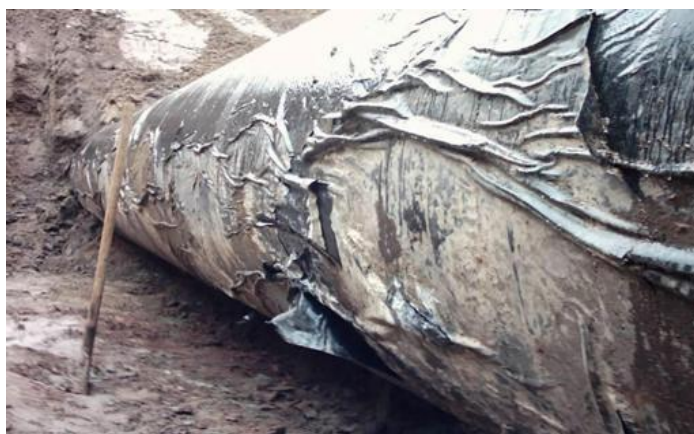
Рисунок 3 – Дефекты изоляционного покрытия [5]
