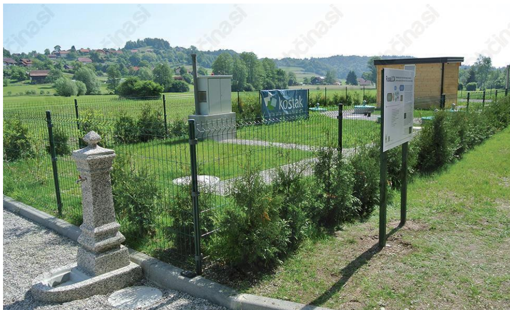
Slika 2.1: Mala Čistilna naprava RusaLCA v občini Šentrupert [13]
