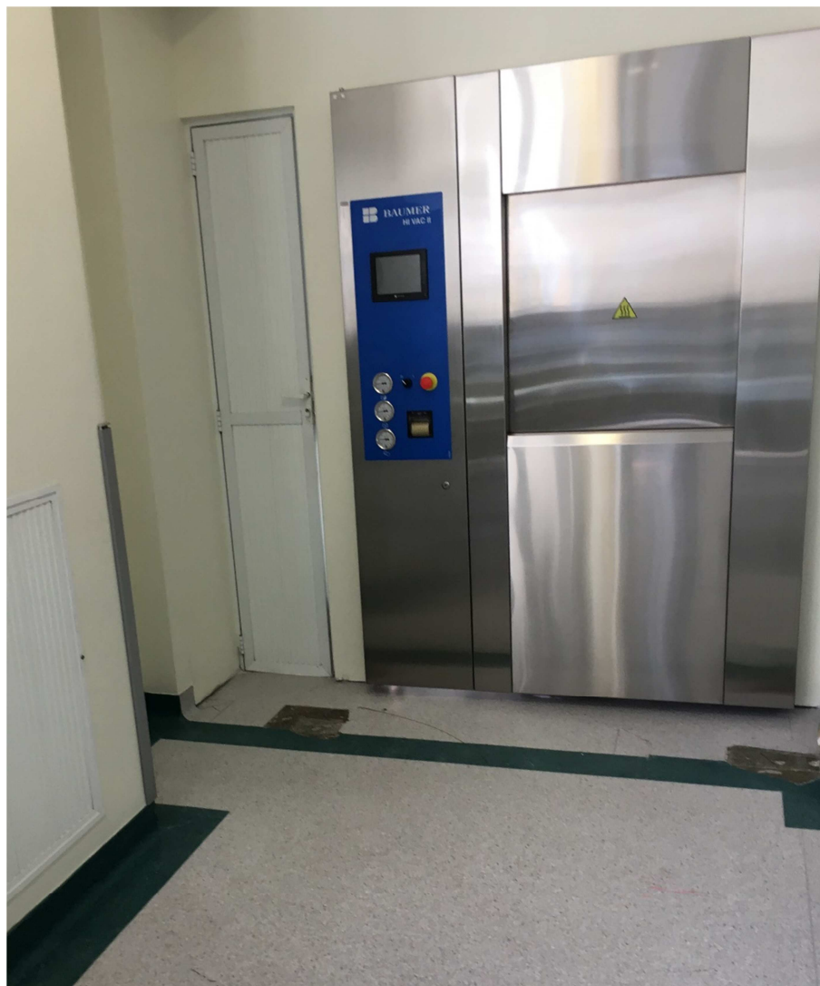
Figura 23 - Área suja da sala das autoclaves do hospital D. Fonte: A autora.
