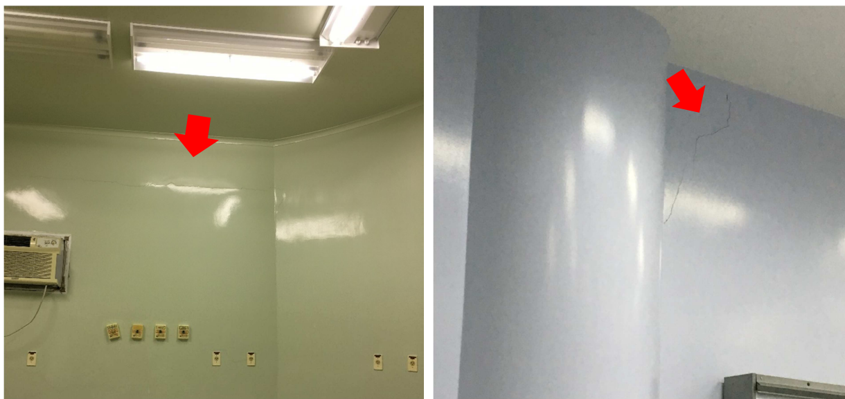
Figura 38 - Fissuras nas paredes das salas cirúrgicas do hospital C (esq.) e D (dir.). Fonte: A autora.
