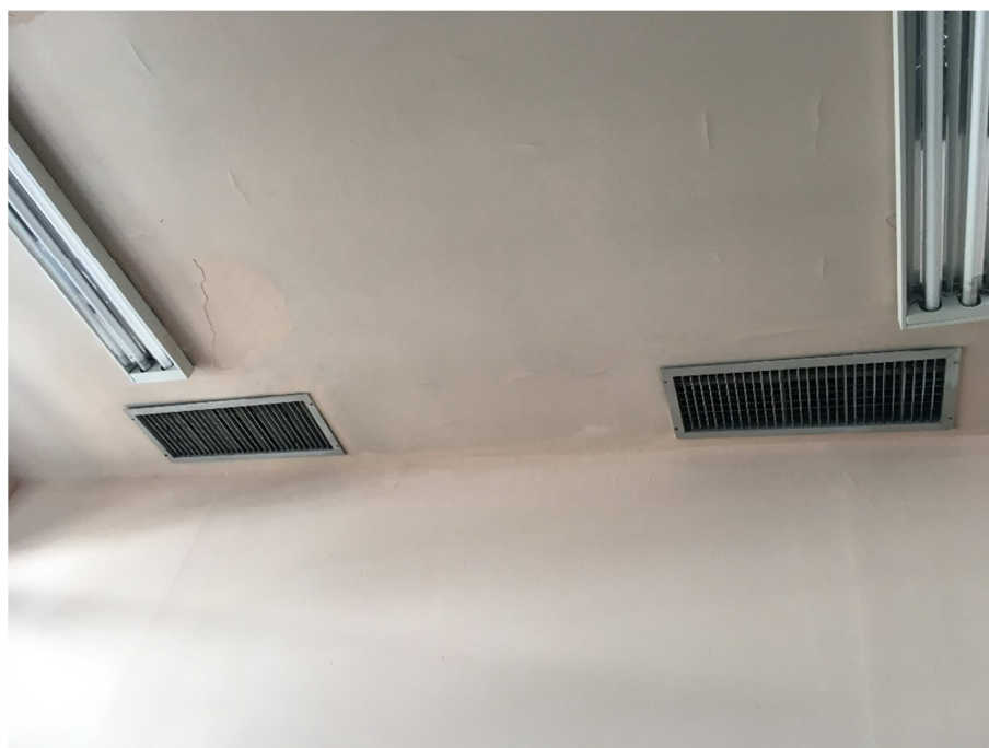
Figura 40 - Descascamento da tinta do teto na sala das autoclaves do hospital C. Fonte: A autora.
