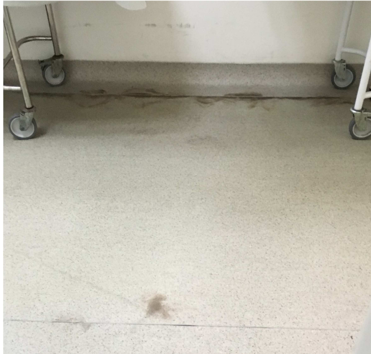
Figura 34 - Manchas e descolamento das juntas da manta vinílica do hospital D. Fonte: A autora.
