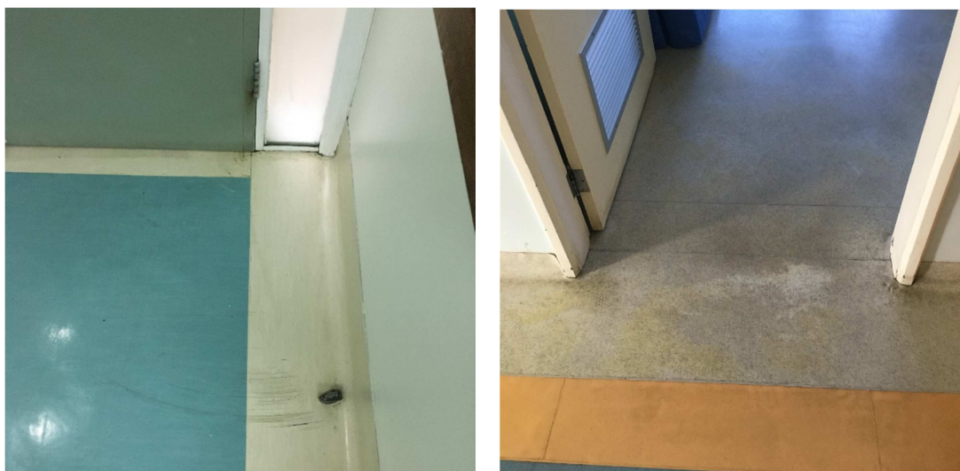
Figura 43 - Riscos e manchas nas vinílicas das UTI dos hospitais A (esq.) e E (dir.).
