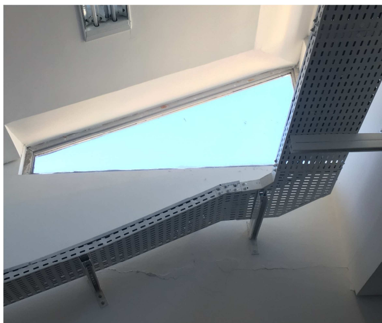
Figura 50 - Infiltração na parede próxima à janela da rouparia do hospital E. Fonte: A autora.
