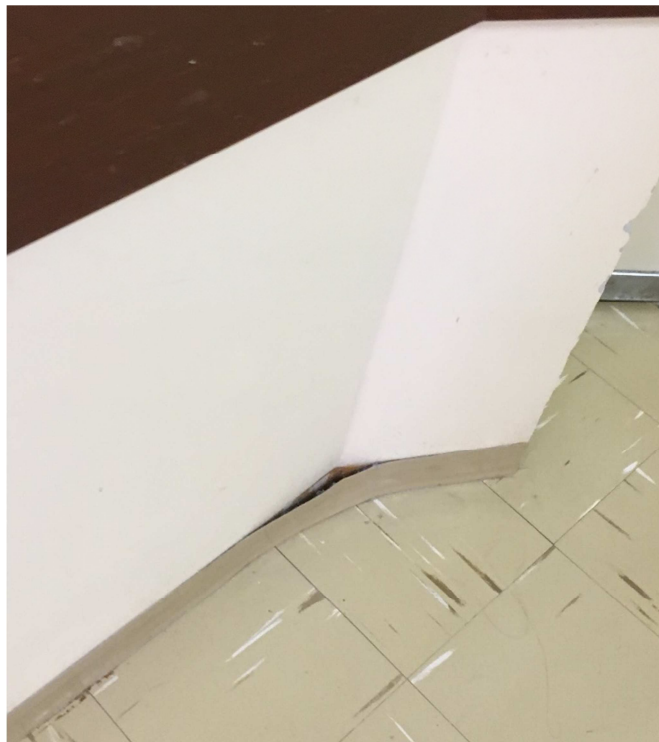
Figura 37 - Descolamento do rodapé do hospital C. Fonte: A autora.
