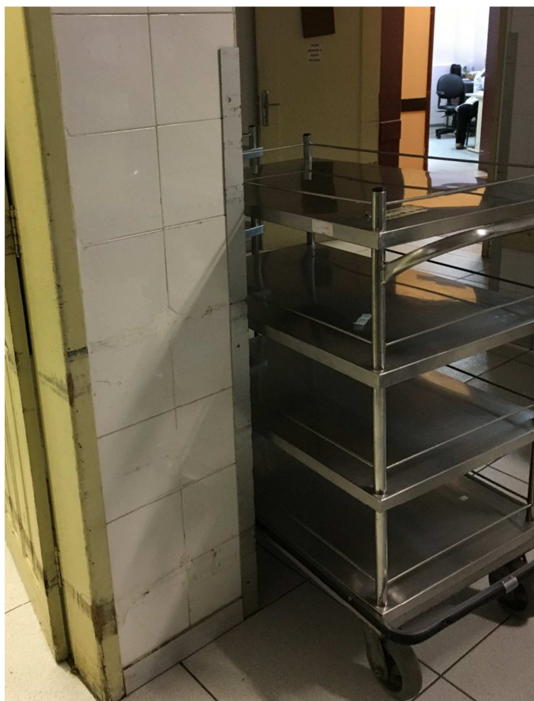
Figura 47 - Riscos nas paredes do hospital C devido às colisões com veículos. Fonte: A autora.
