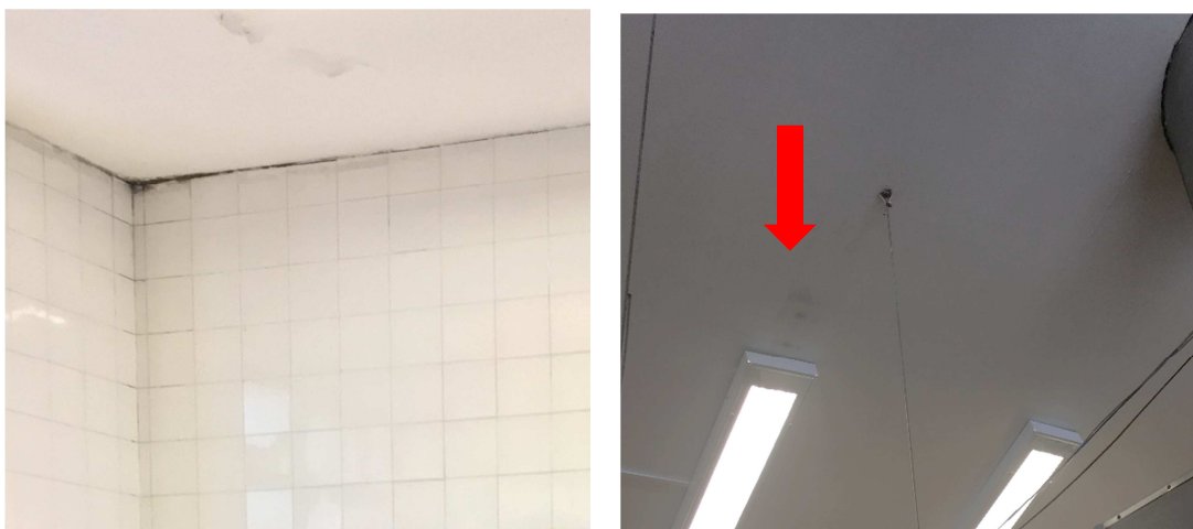
Figura 46 - Bolor e manchas presentes nos tetos das cozinhas do hospital C (esq.) e E (dir.), respectivamente. Fonte: A autora.
