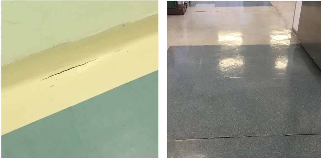
Figura 41 - Fissuras (esq.) e descolamento (dir.) nas mantas vinílicas dos hospitais A e E, respectivamente. Fonte: A autora.
