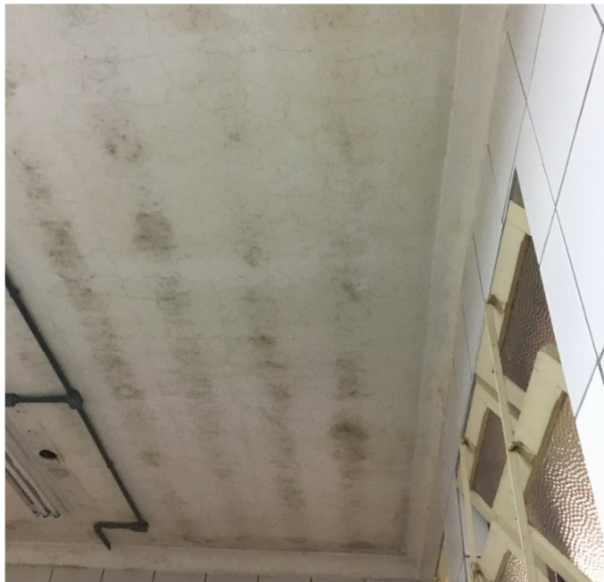
Figura 51 - Bolor e fissuras no teto da rouparia do hospital C. Fonte: A autora.
