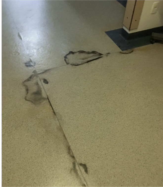
Figura 36 - Manchas nas juntas da manta vinílica do centro cirúrgico do hospital D. Fonte: A autora.
