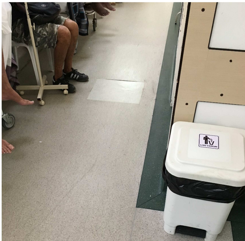
Figura 24 – “Remendo” de parte da manta vinílica do corredor da emergência do hospital D. Fonte: A autora.
