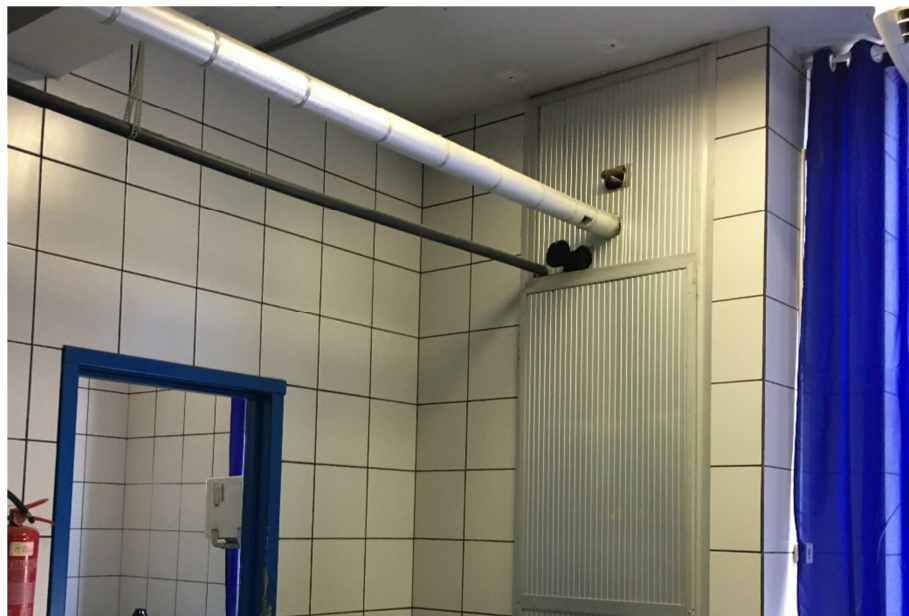
Figura 26 - Tubulações em desuso na rouparia do hospital D. Fonte: A autora.
