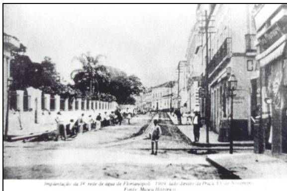
Figura 35 – Praça XV de Novembro e a implantação da rede de água em 1909
