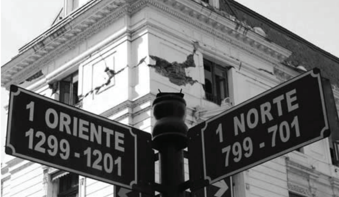
After the earthquake in Talca / Después del Terremoto en Talca
