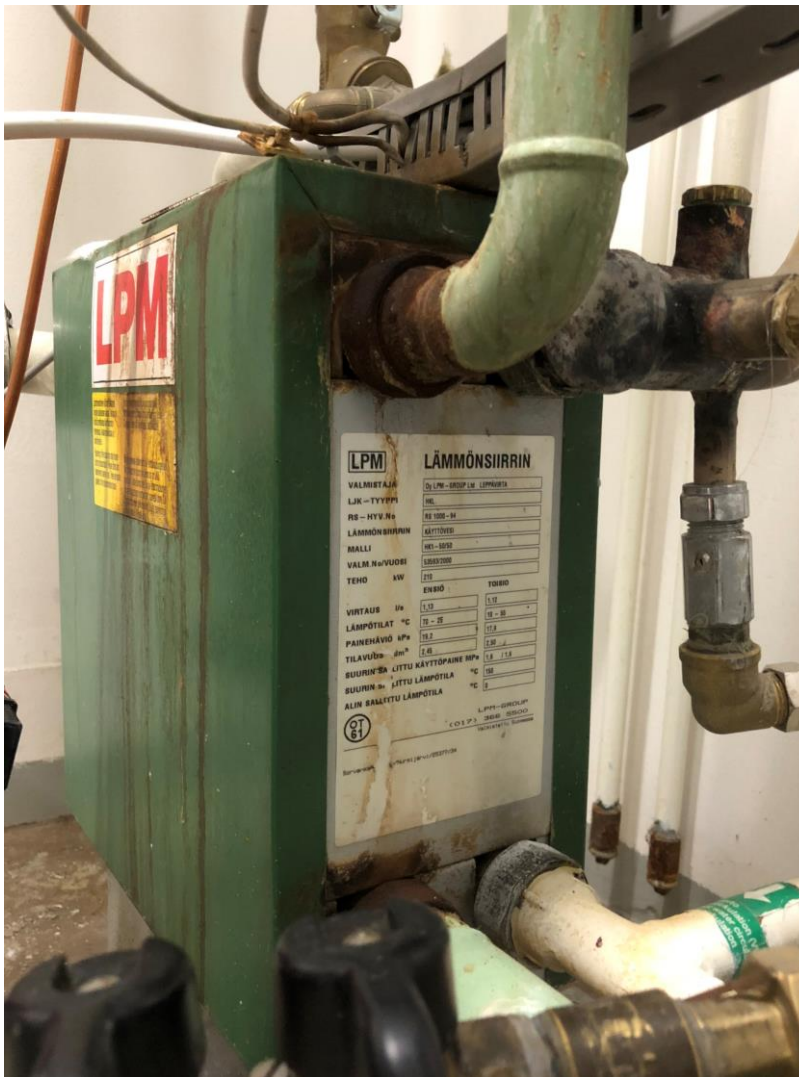
Kuva 2. Vanha käyttöveden lämmönsiirrin.
