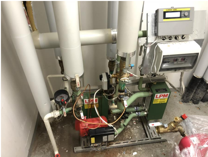
Kuva 1. Kuvassa alkuperäinen lämmönjakokeskus.
