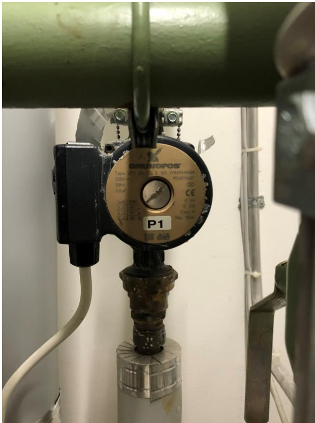
Kuva 5. Vanha käyttöveden pumppu.
