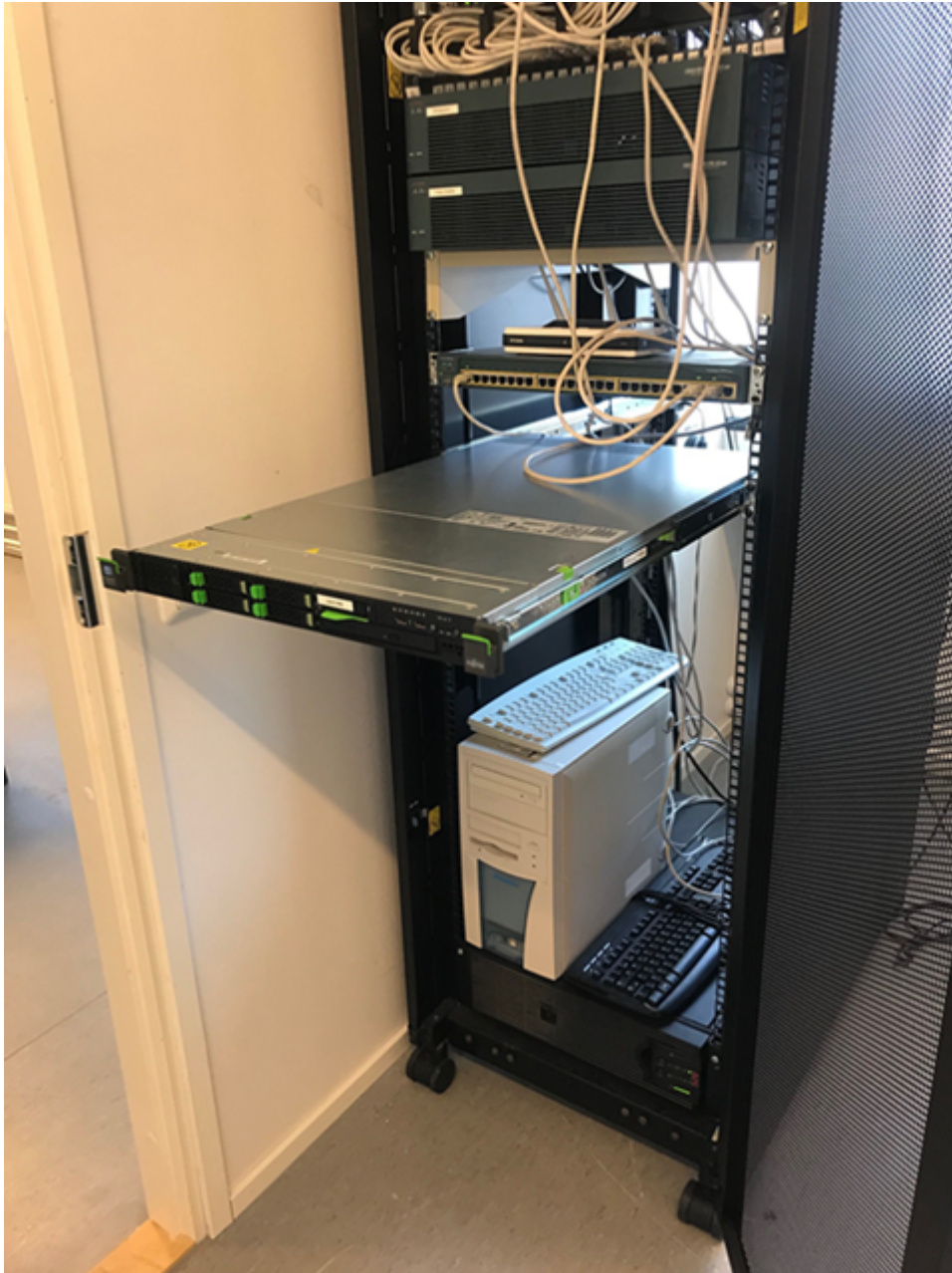
Kuva 12. Palvelinlaitteen kiskot, joiden päälle palvelin on laskettu.
