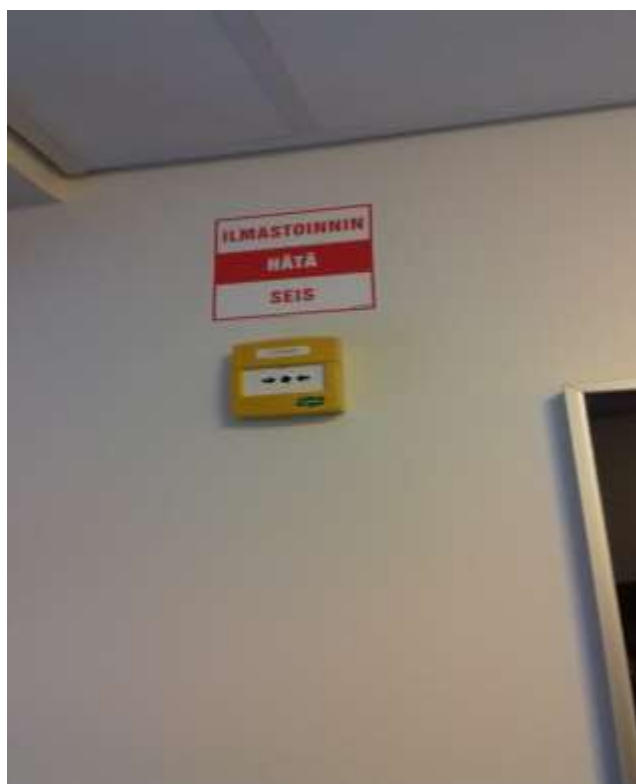
Kuva 4. Esimerkkikohteen ilmastoinnin pysäytyspainike.
