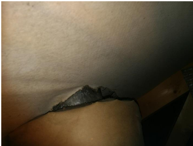
Kuva 6. Aluskatteen läpiviennit eivät ole tiiviitä.
