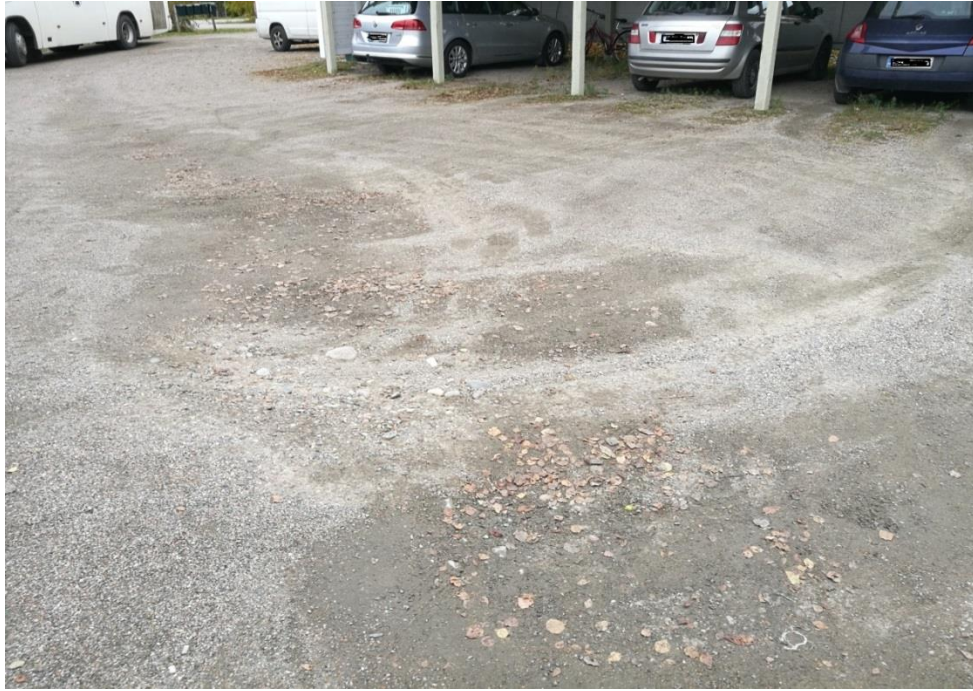
Kuva 3. Pihan liikennealueessa monttuja joihin vesi lammikoituu.
