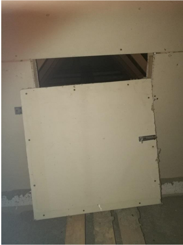
Kuva 7. Yläpohjan palo-osastoinnin kulkuluukut ovat huonossa kunnossa.
