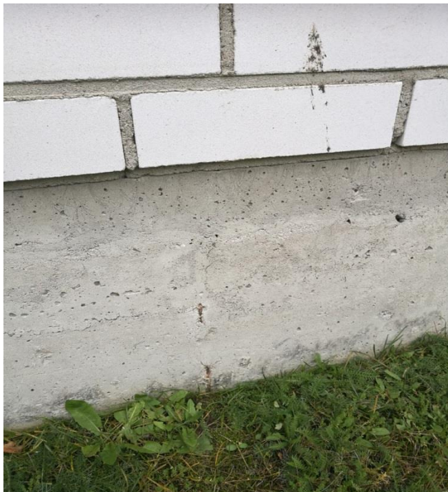
Kuva 4. Raudoitukset näkyvät sokkelissa.
