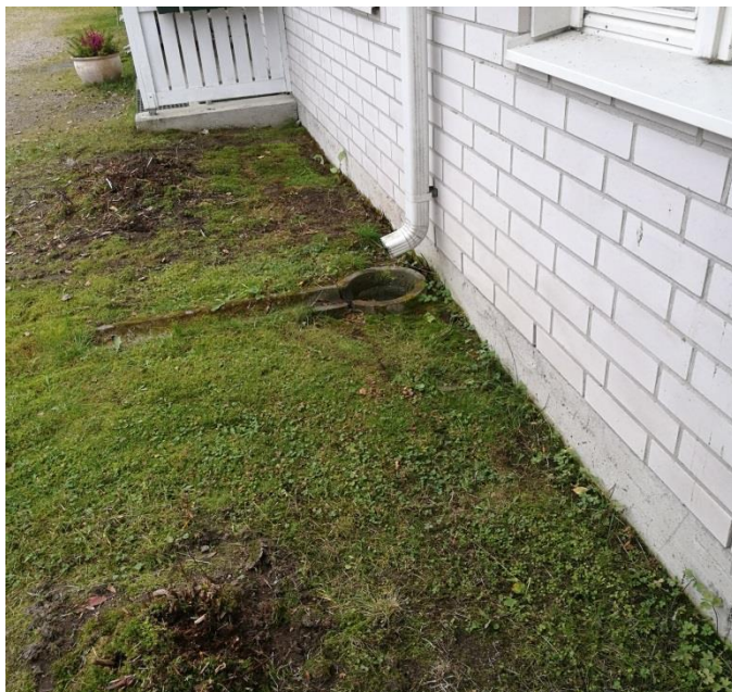
Kuva 1. Vesi pääsee etenkin etupihan puolella valumaan perustuksiin ja kasvillisuus ulottuu perustuksiin asti.
