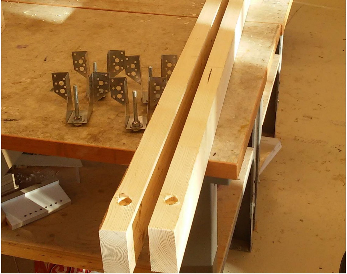
Kuva 17. Kaksi runkopalkkia ja palkkikenkiä
