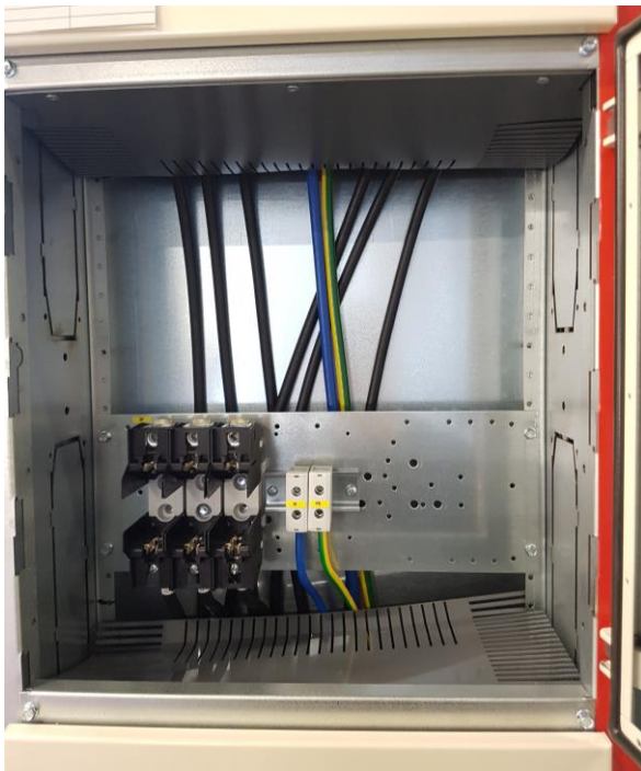
KUVA 18. Kotelu/kojekenttä kansi avattuna
