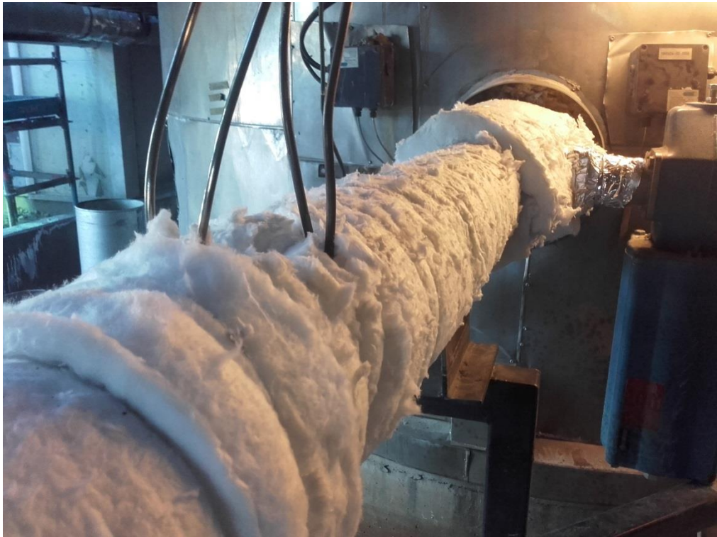
Kuva 5. Eristyksessä on varmistettu riittävä eristeen limitys.
