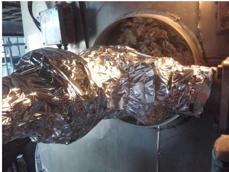
Kuva 1. Reaktorista tuleva putki on päällystetty alumiinifoliolla.
