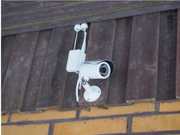
Kuva 20. Kotihälytin Mini Platinum -sarjan kamera omakotitaloon asennettuna.
