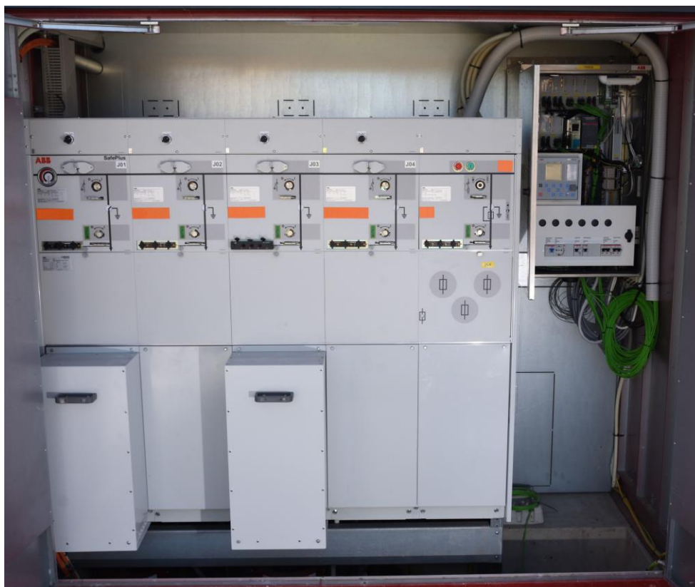
Figur 3. Mellanspänningsställverk och skåp med automationskomponenter i transformatoriosk.
