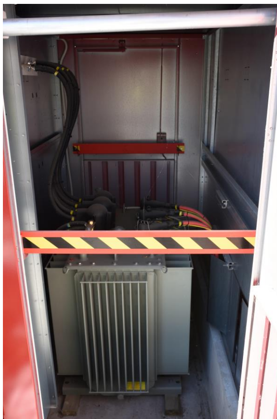
Figur 5. Transformator i transformatorkiosk.
