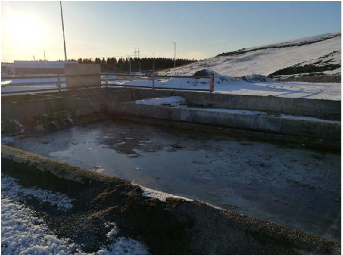
KUVA 3. Muiden nestemäisten jätteiden vastaanottoallas, ns. hiekkakaivoallas
