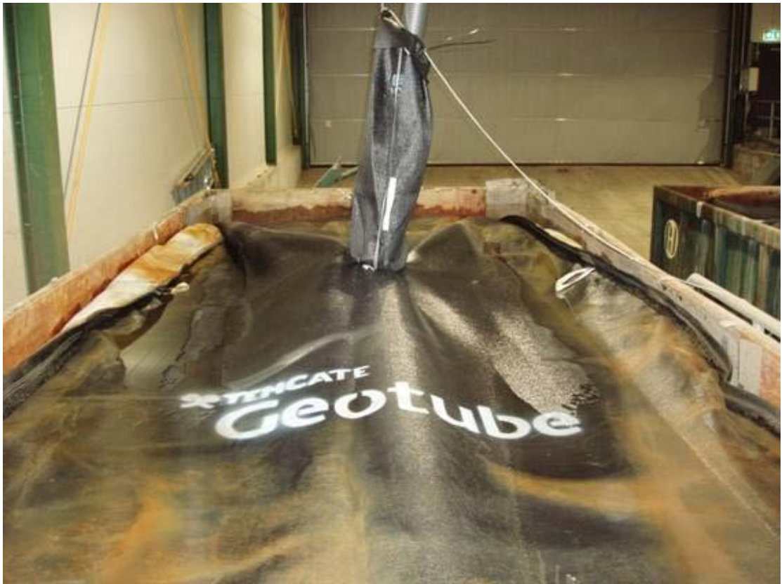
KUVA 7. TenCate Geotube® vaihtolavalla lietehallissa (Sito Oy:n materiaali, ystävällisesti heidän luvallaan)
