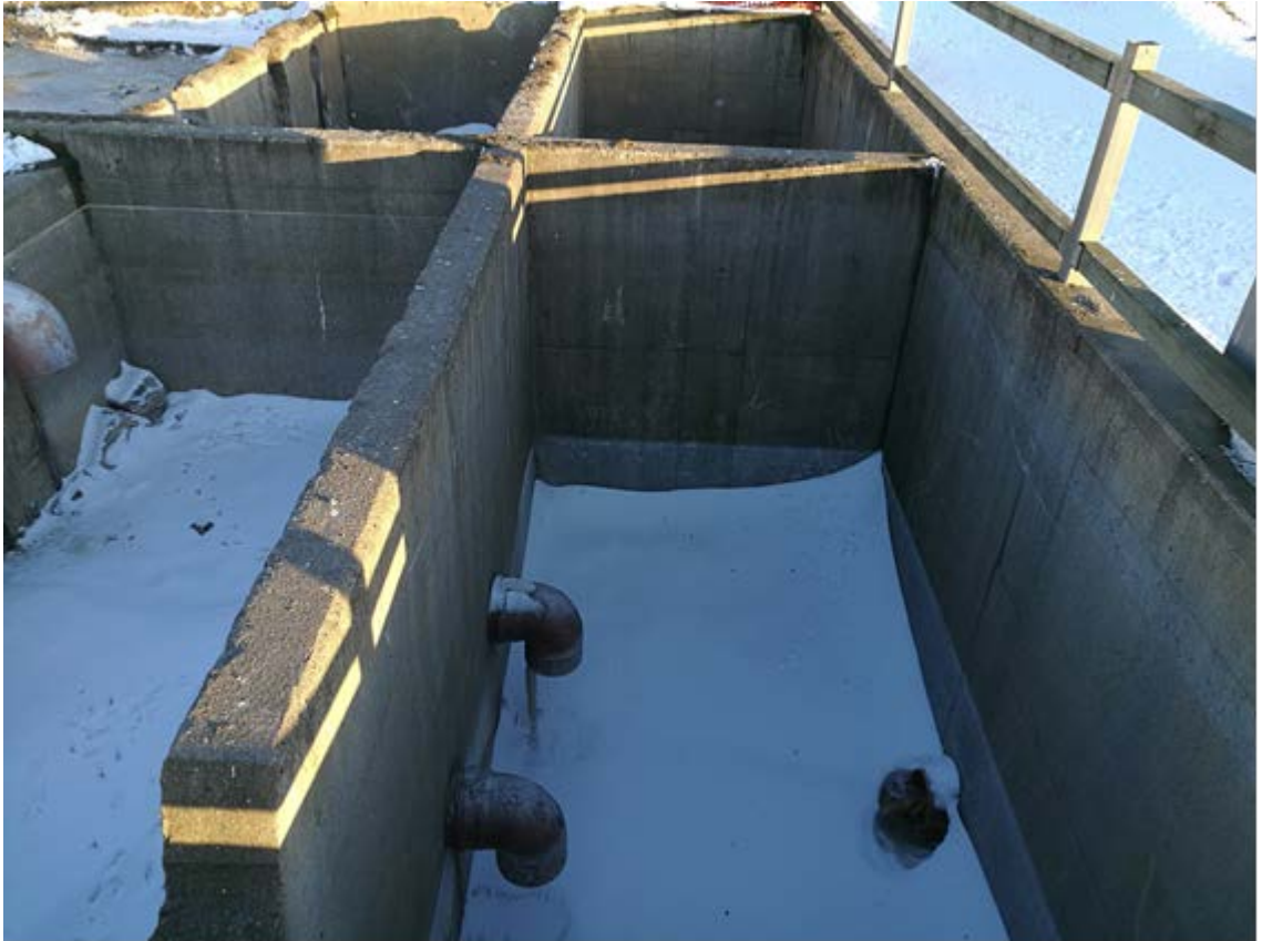
KUVA 2. Rasvanerotuskaivojätteiden käsittelyaltaat etualalla, muiden nestemäisten jätteiden altaat taaempänä
