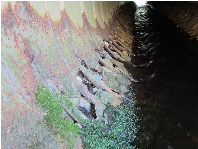
KUVA 7. Rumpu ruostunut puhki (Sitowise 2016)
