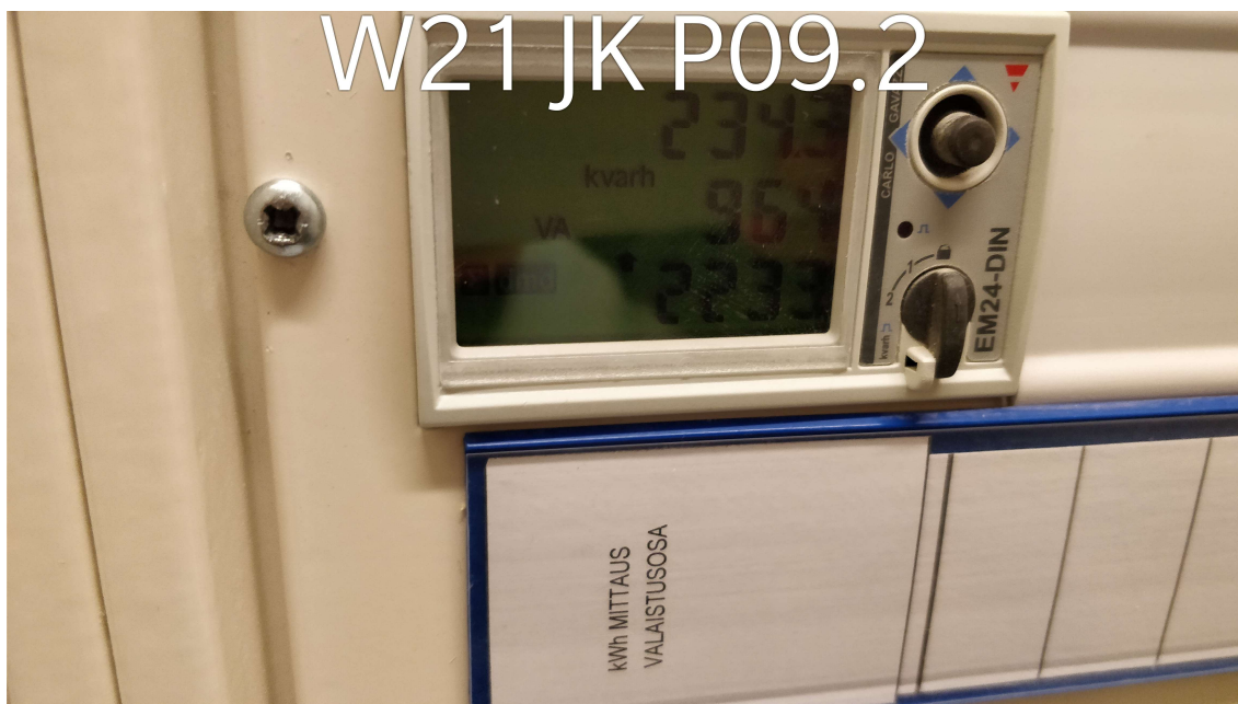
Kuva 14. yhdeksännen kerroksen jakokeskuksen energiamittari.
