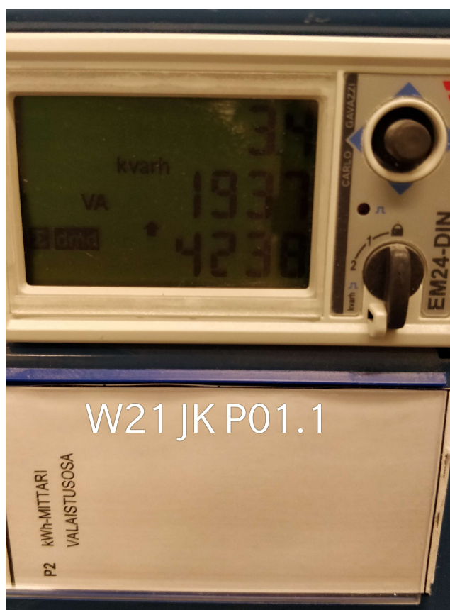
Kuva 16. Jakokeskuksen W21 JK P01.1. energiamittari.
