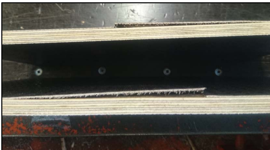
KUVA 7. Pullistunut pintaviilu ja revennyt pinnoite sivusta
