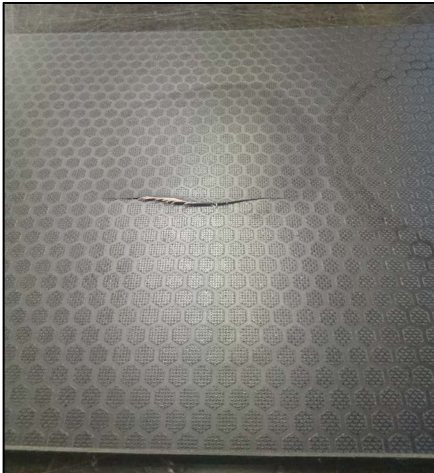
KUVA 6. Pullistunut pintaviilu ja revennyt pinnoite
