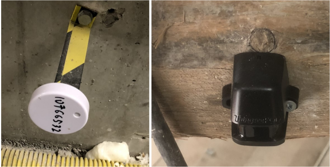
Kuva 7. Vasemmalla RuuviTag asennettuna kattoon itse tehdyn kiinnikkeen avulla ja oikealla Thingseen Pod-anturi putoamissuojan välijohteeseen asennettuna.
