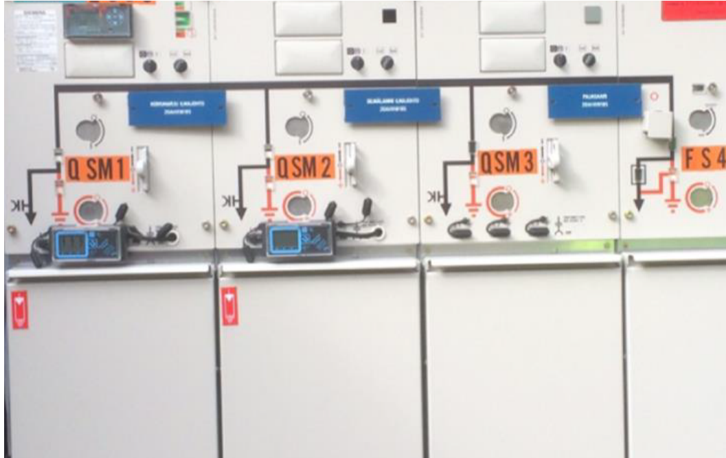
Kuva 6. 3+1 -kojeisto varustettuna 2+1 -laitteiston vikaindikaattorilla sekä jänniteilmaisimin. Valmistajina kojeistolla Siemens ja muuntamoautomaatiokomponenteilla Kries [6].
